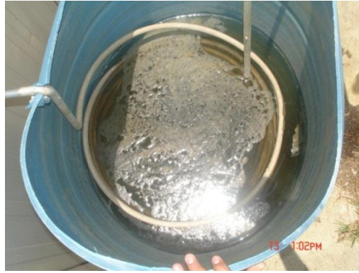
Ilustración 12. Vista interna del condensador que utiliza LAPEM para la obtención de muestras de fluido geotérmico.
