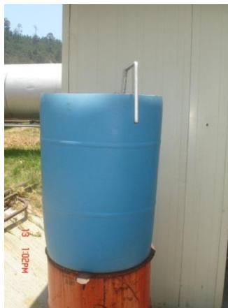
Ilustración 11. Vista externa del condensador que utiliza LAPEM para la obtención de muestras de fluido geotérmico.
