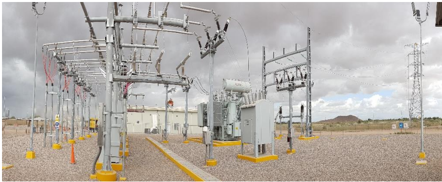
Vista lateral de subestación elevadora
