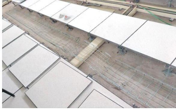
Figura 1-9 Charolas para canalización (propia)
