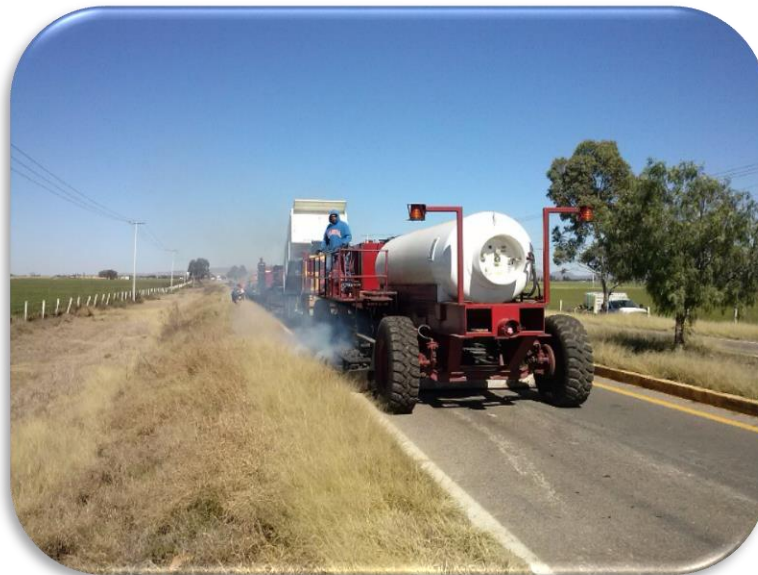
Ilustración 28: Precaentador trabajando. (MMG, 2019)
