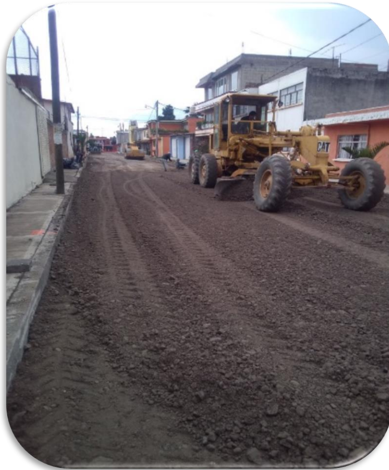
Ilustración 11: Base Hidráulica en Municipio de Metepec Edo México. (MMG, 2019)
