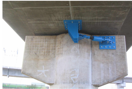
(b) Amortiguador viscoso instalado transversalmente en el Puente Dong-Yun, Corea del Sur
