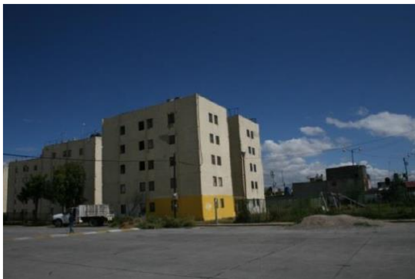
Foto 11. Inclinación de edificios por hundimiento. Colonia Verde Claro, Tultitlán de Mariano Escobedo.
