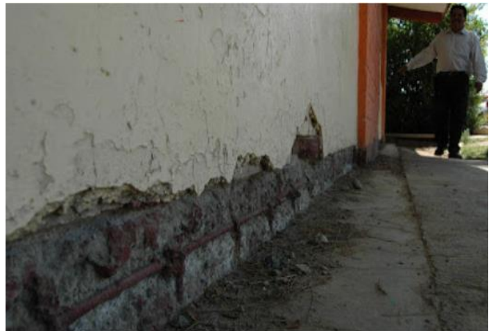
Foto. 16. Daños en la fachada del Jardín de niños Lorenzo Filho.
