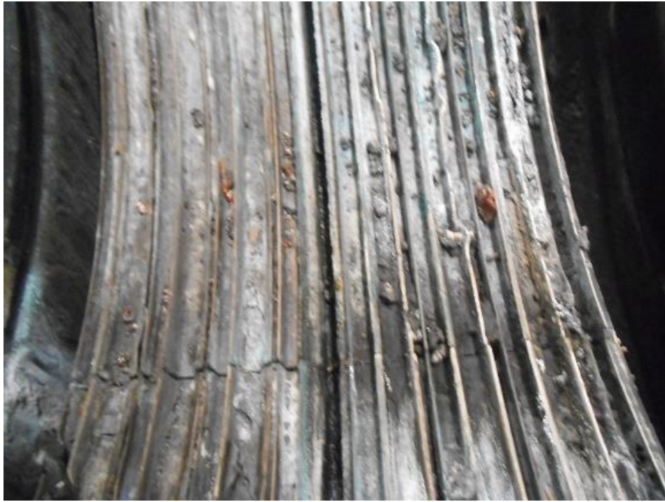
Figura 3.16 Sistema de sellos de vapor dañado, con residuos de materiales diversos.
