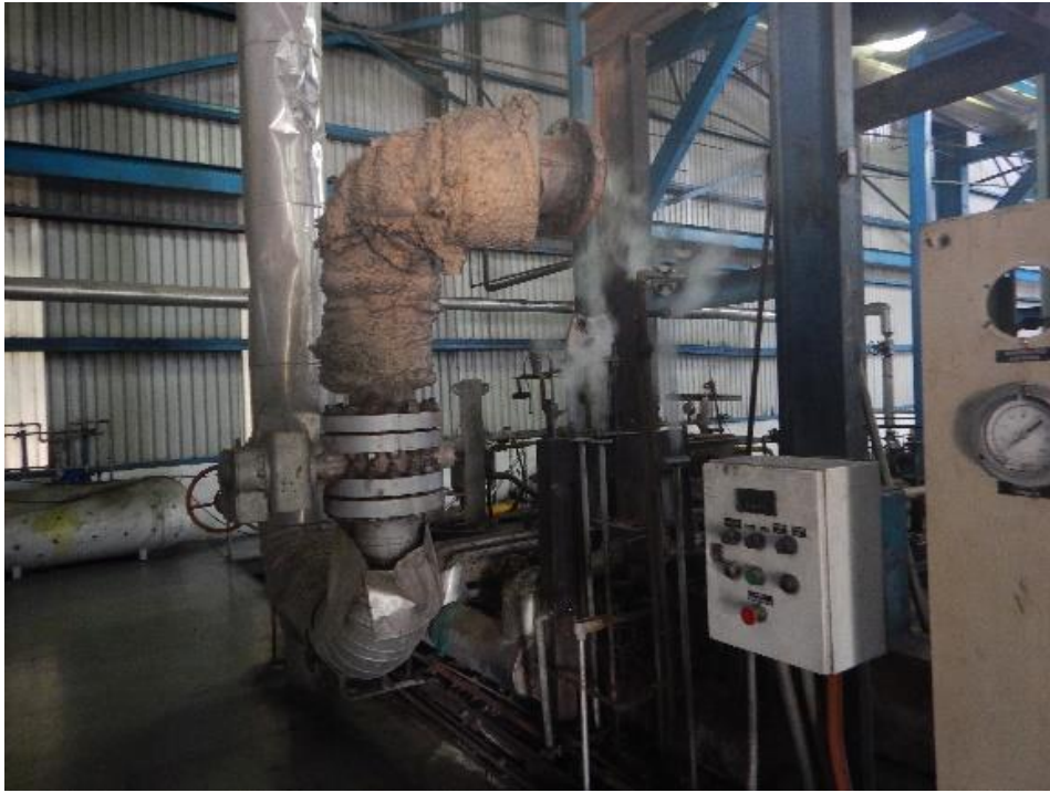
Figura 3.28 Tuberías dañadas por incendio en chumaceras.
