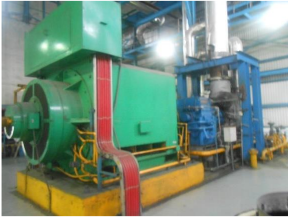
Figura 3.10 Sistema completo de cogeneración previo al siniestro, vista frontal, no se observan afectaciones en el equipo.
