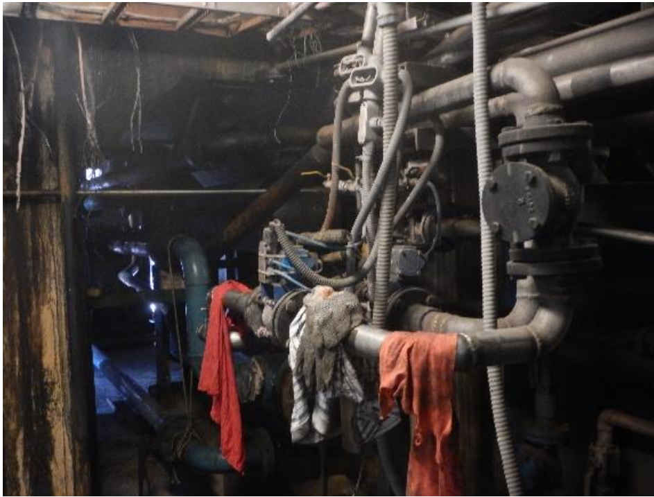
Figura 3.23 Sistema de lubricación con fugas.
