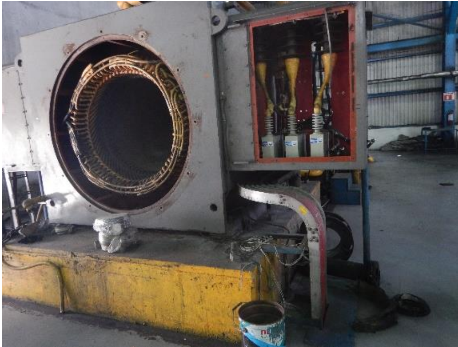
Figura 3.20 Estator del generador dañado con testigos de incendio.
