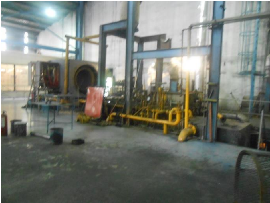
Figura 3.4 Afectaciones en planta de cogeneración del ingenio azucarero.
