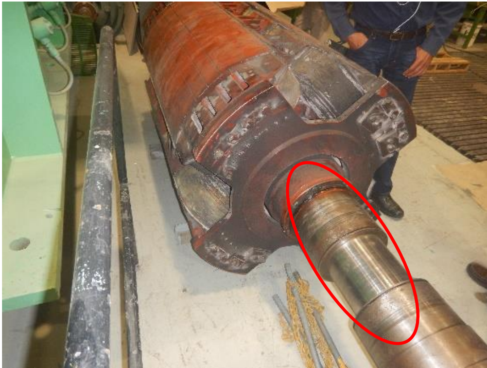
Figura 3.19 Rotor del generador afectado en su eje, presentando desbaste por sobreaceleración.
