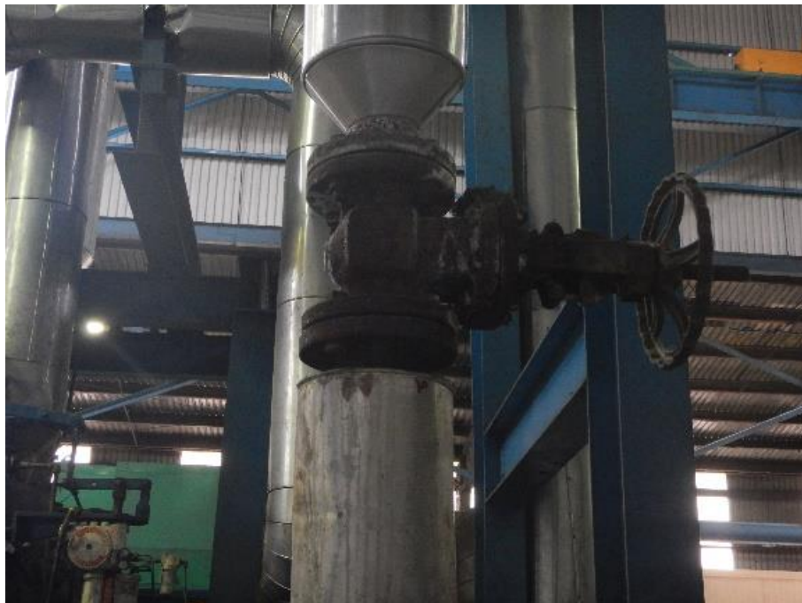
Figura 3.22 Válvula de vapor del sistema de cogeneración.
