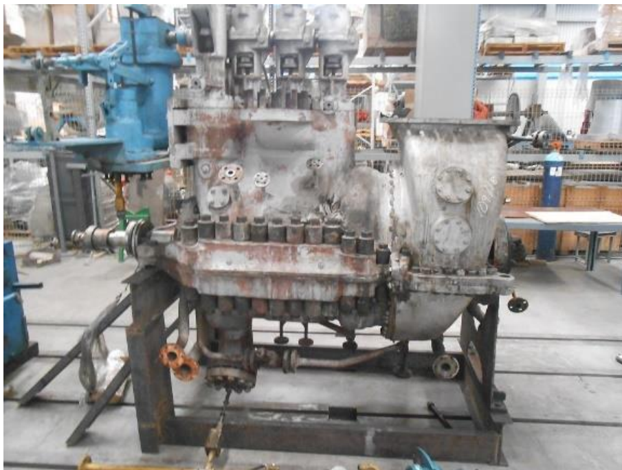
Figura 3.12 Monoblock de la turbina afectada.
