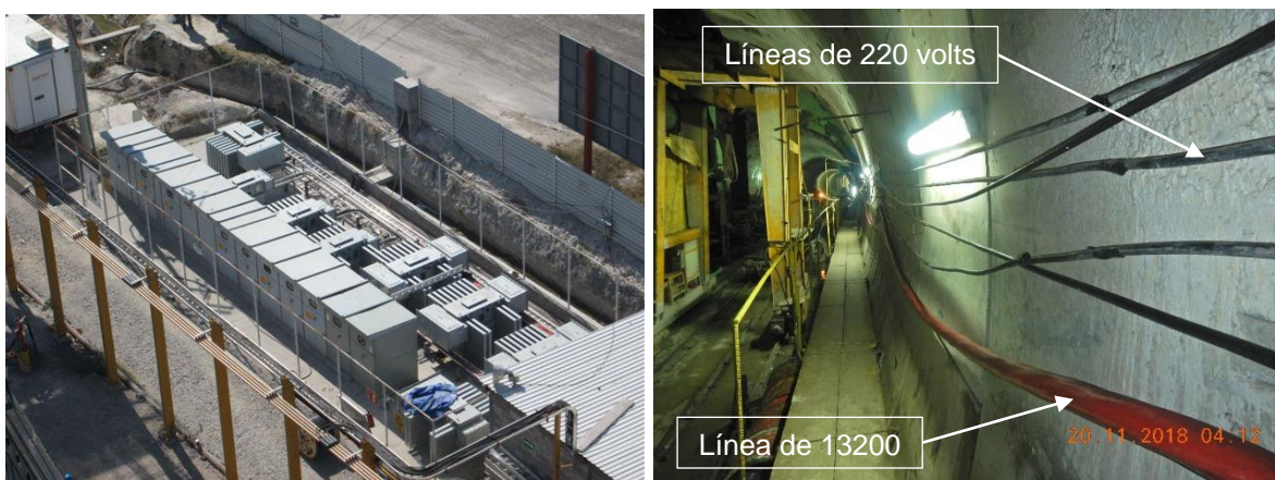
Figura 154. Subestación eléctrica de y líneas de suministro de energía en túnel.
