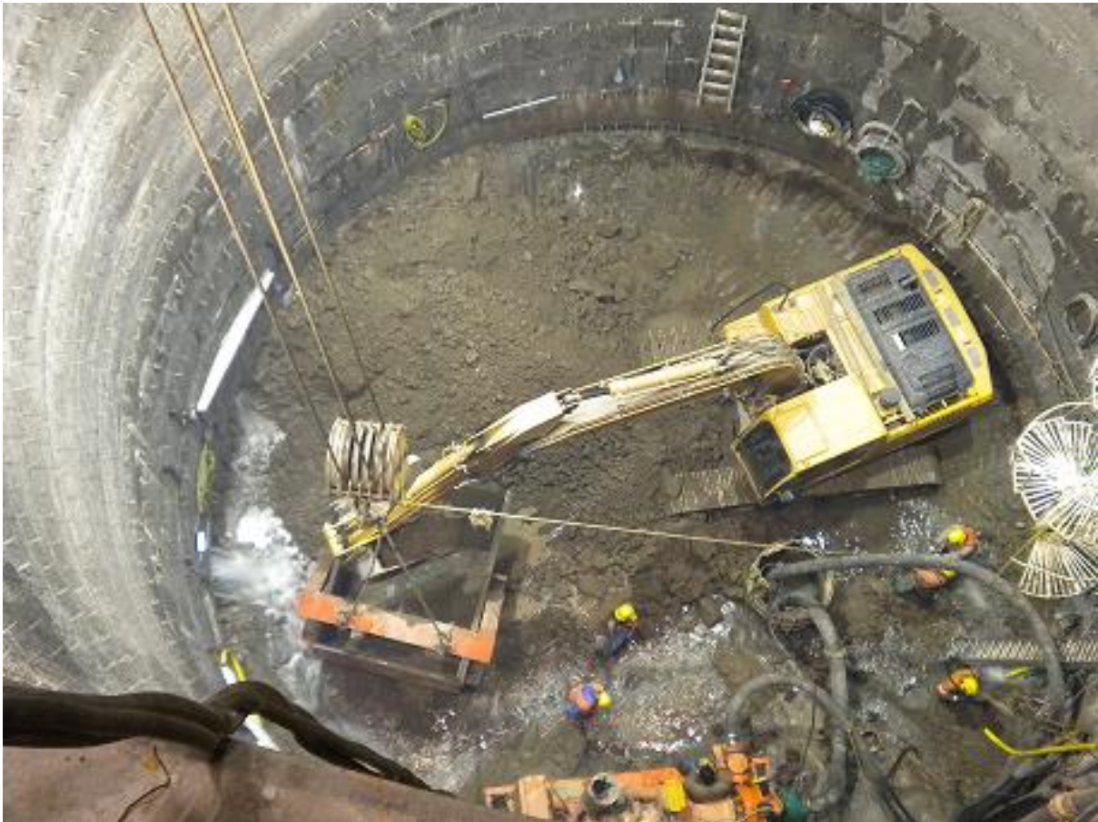
Figura 10. Excavación de núcleo y colocación de marcos metálicos para construcción de la lumbrera.
