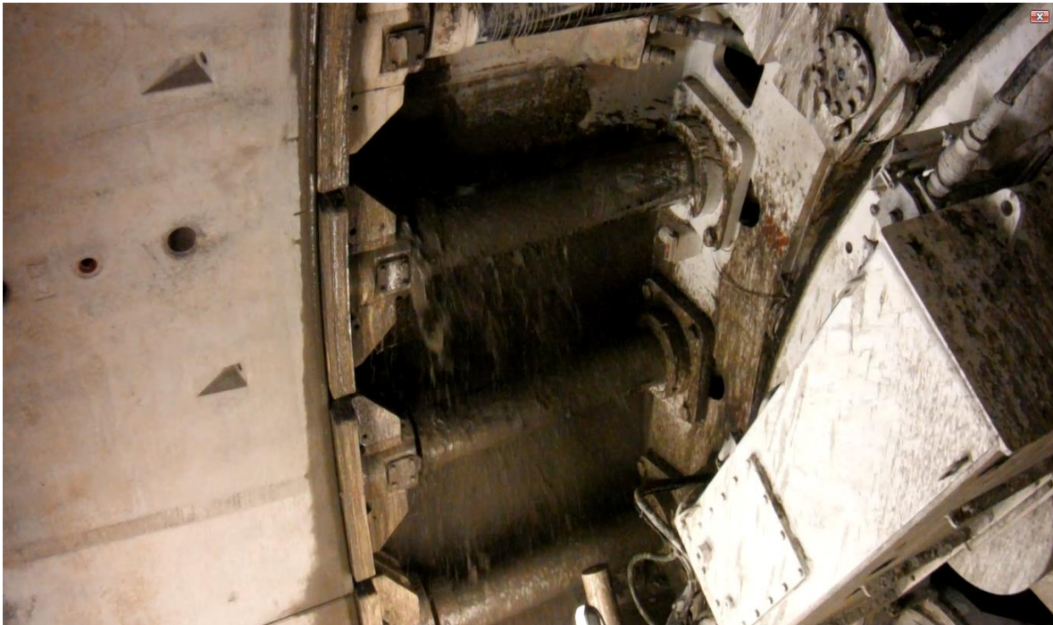
Figura 284. Salida de mortero en zona de cepillos.
