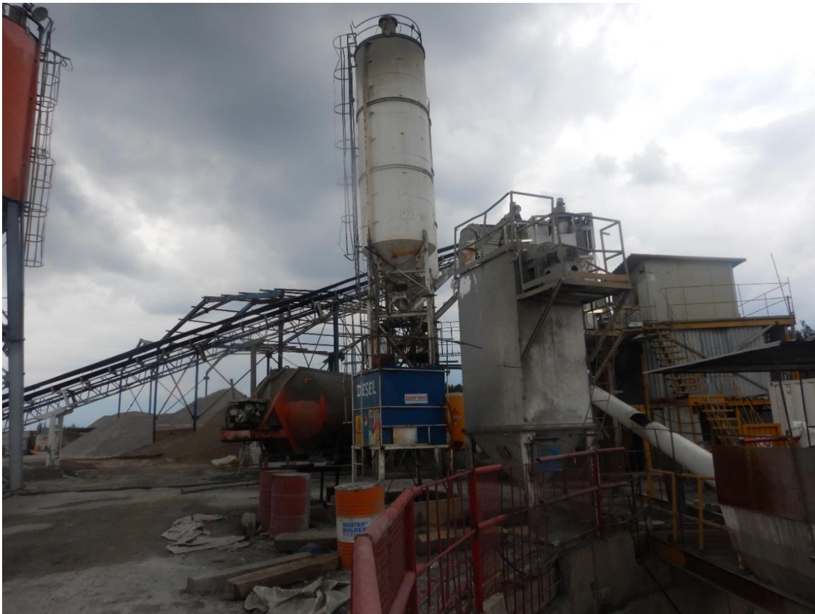
Figura 109. Planta dosificadora utilizada para fabricación de concreto.
