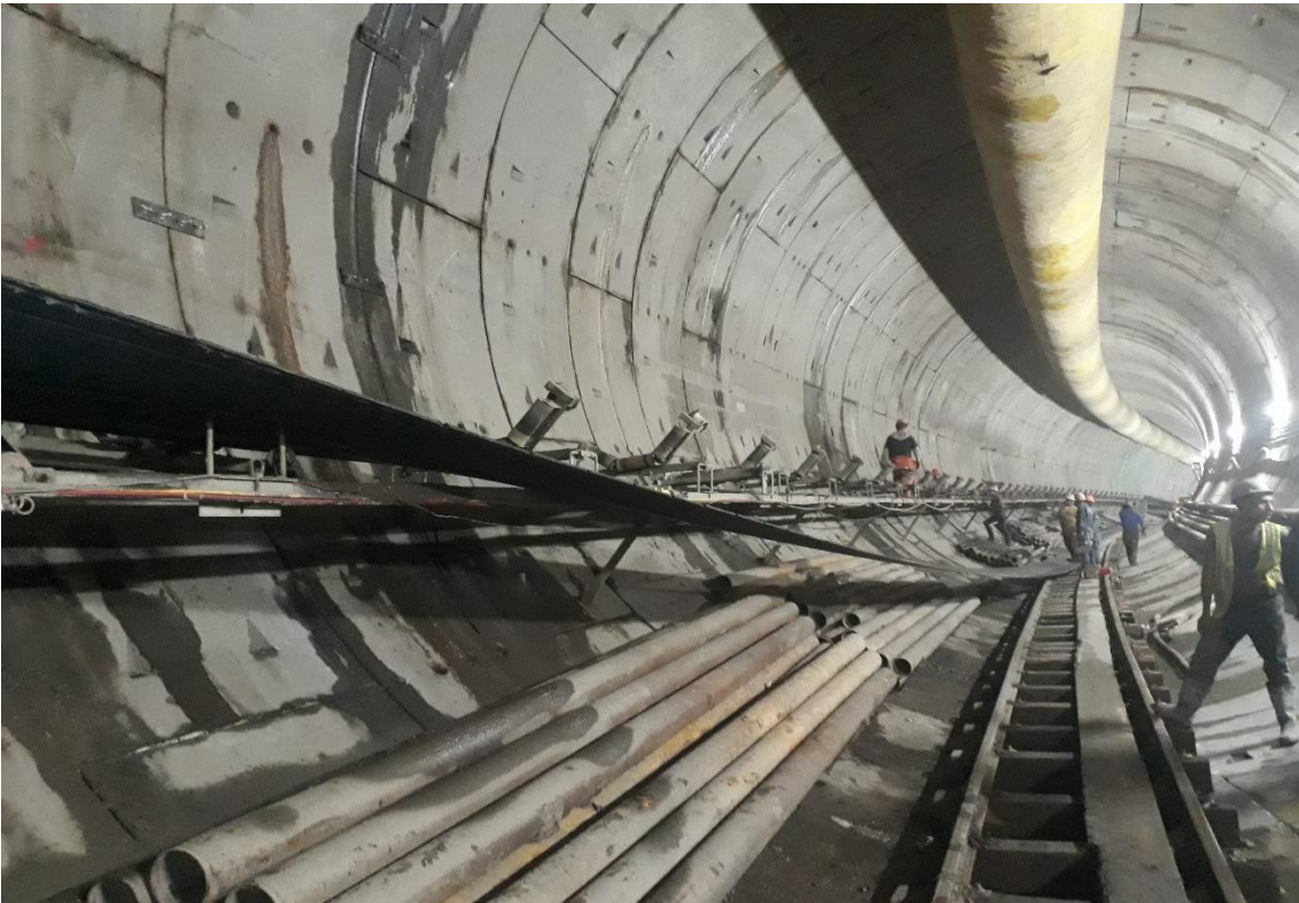
Figura 287. Desalineamiento de banda horizontal.
