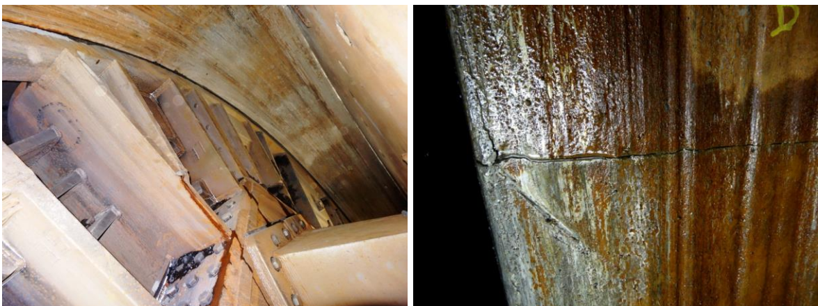
Figura 264. Daño presentado en cámara de excavación.
