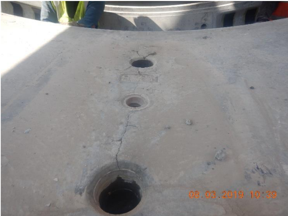
Figura 311. Daño por fractura en dovela.
