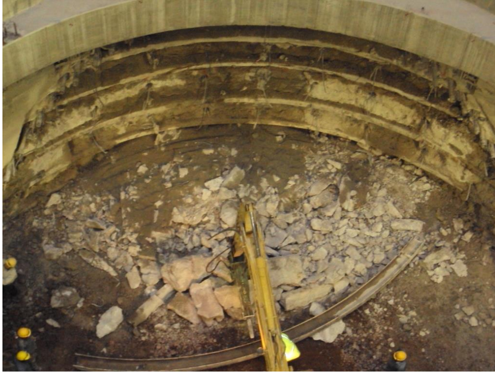
Figura 64. Retiro de marcos metálicos del revestimiento primario de la lumbrera para la construcción de la galería.
