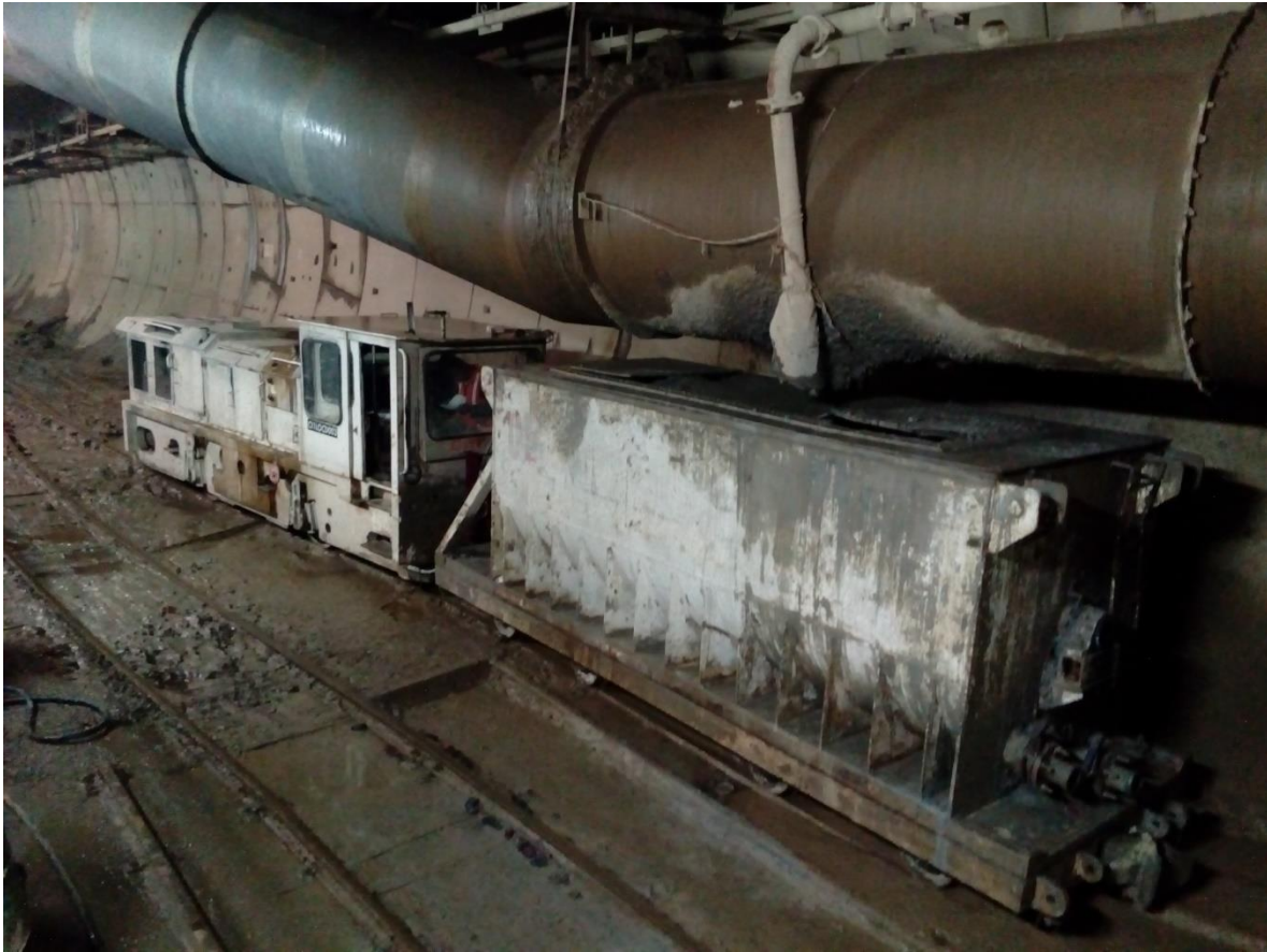
Figura 143. Transportador helicoidal de 8.5 m 3 .
