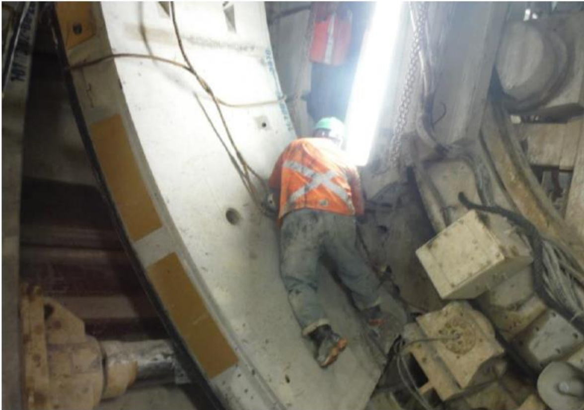
Figura 286. Caída de dovela por falla en erector.
