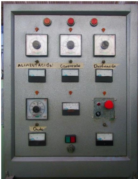
Ilustración 9. Unidad de control
