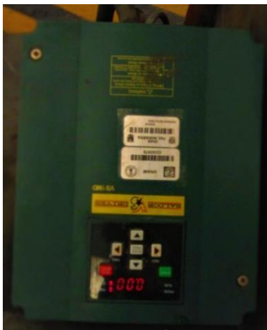
Ilustración 10. Variador de frecuencias
