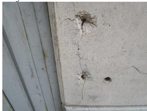
Figura 3.56. Fisuras en muro. Foto 16.
