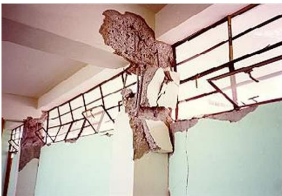
Figura 1.11. Fallas estructurales causadas por alta vulnerabilidad en edificaciones: columna corta. (Arancibia, 2012)
