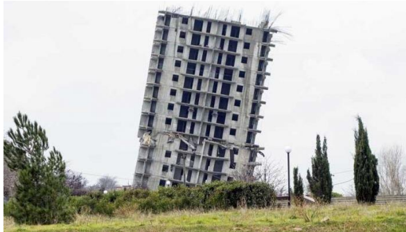
Figura 2.20. Pérdida de verticalidad. (IDC, 2019)
