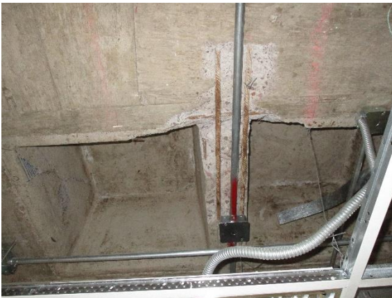
Figura 2.13. Pérdida de recubrimiento. (DE-DICYG, 2018)
