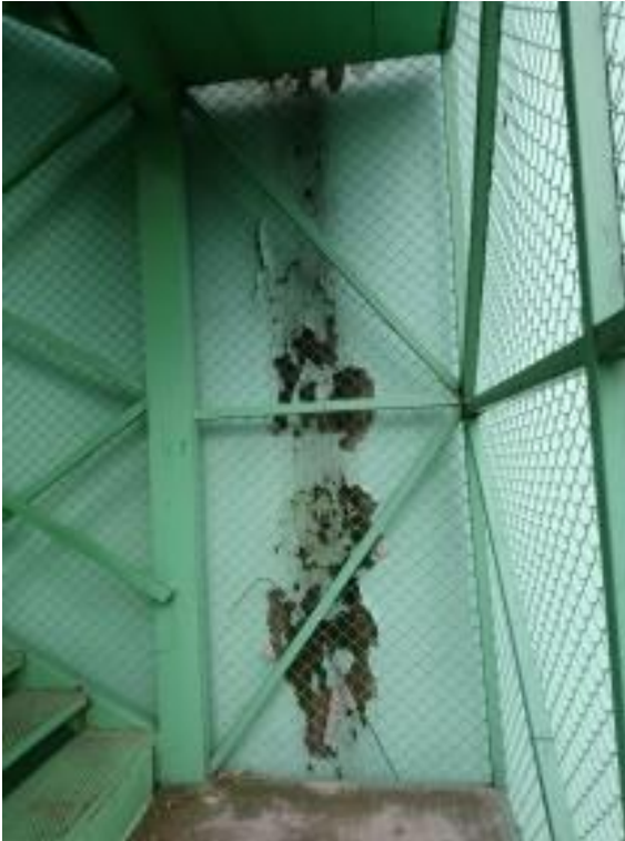
Figura 3.12. Deterioro del concreto por humedad. (GACONSA, 2018)
