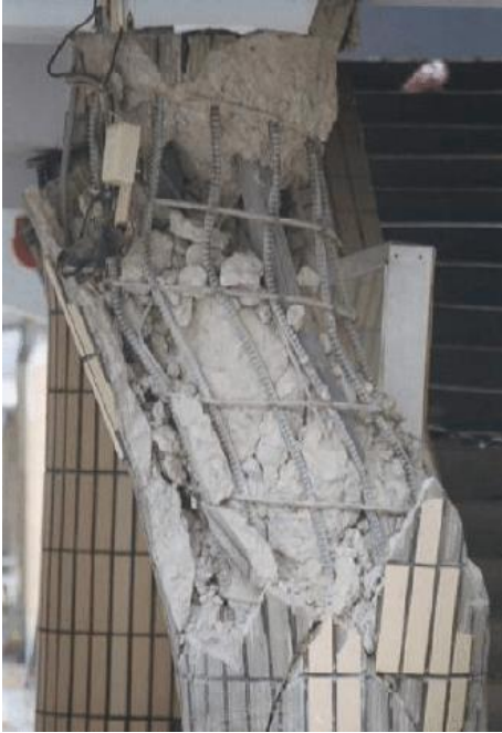
Figura 2.17. Falla por flexocompresión en columna de concreto y pandeo de acero de refuerzo. (Mortezaei, Kheyroddin, y Ghodrati, 2008)
