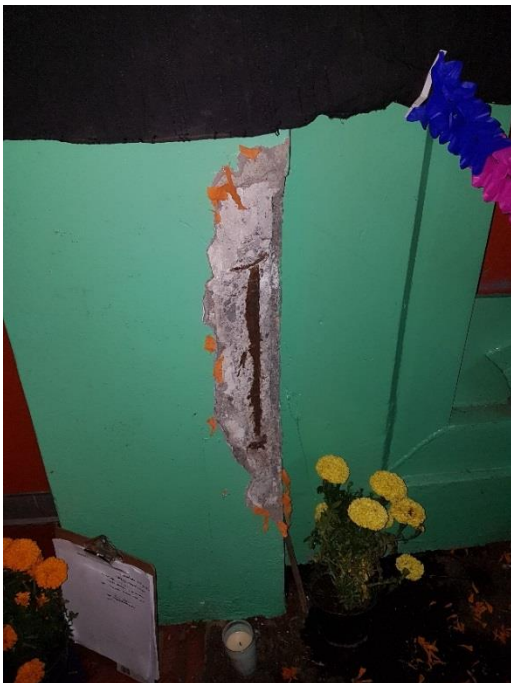
Figura 3.10. Desprendimiento de recubrimiento, exposición y corrosión de acero de refuerzo en columna. (GACONSA, 2018)
