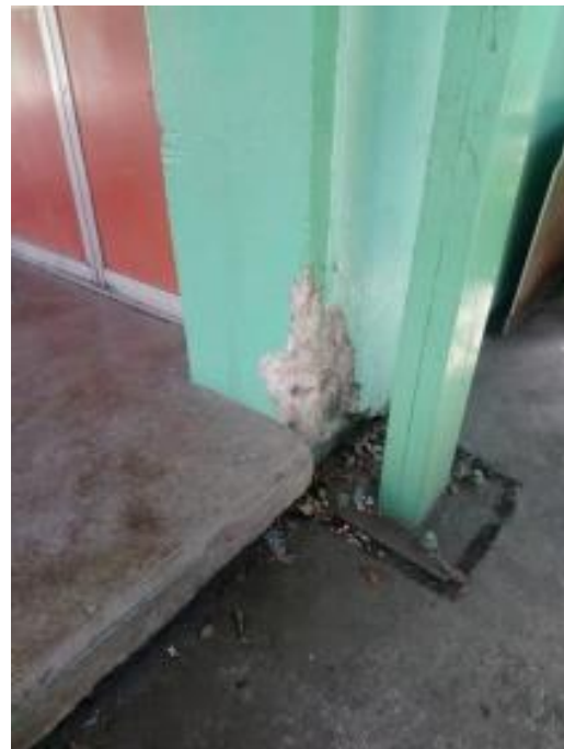
Figura 3.11. Desprendimiento de recubrimiento en base de columna. (GACONSA, 2018)
