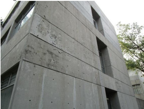
Figura 3.53. Fisuras en muro. Foto 13.
