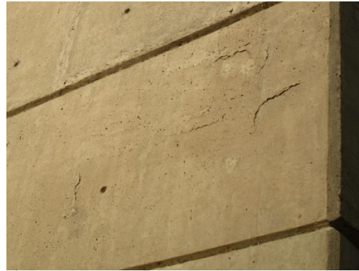
Figura 3.52. Fisuras en muro. Foto 12.
