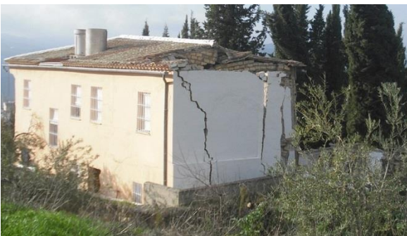
Figura 2.19. Efectos por asentamientos diferenciales. (geotecniafacil.com, 2017)
