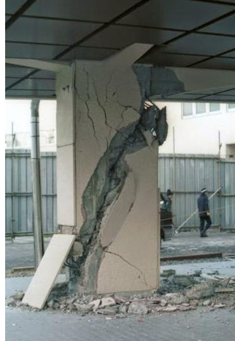
Figura 2.18. Falla por cortante en columna de concreto reforzado. (Michail, 2016)
