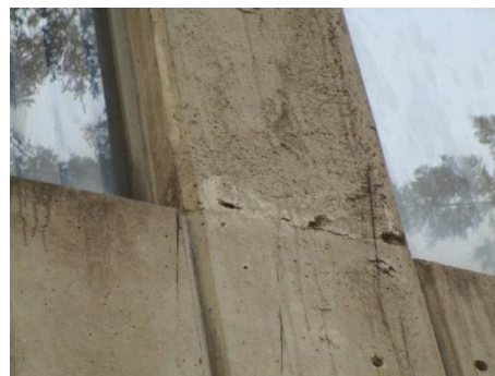
Figura 3.62. Junta fría en unión trabe-columna. Foto 22.
