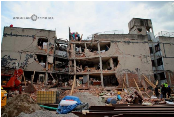
Figura 1.5. Daño severo y derrumbe parcial del edificio de 5 niveles en Saratoga 715, Colonia Portales, Ciudad de México. Vista lateral. (ANGULAR 11-18 MX, 2017)
