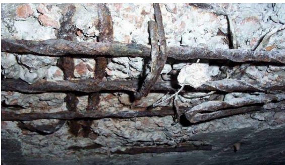
Figura 2.15. Carbonatación y grave deterioro del concreto. (Materiales Ramonsón, 2013)
