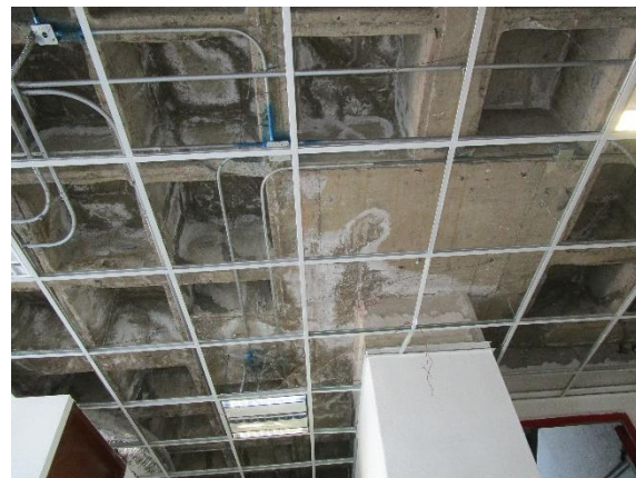
Figura 2.10. Humedad en concreto. (DE-DICYG, 2018)
