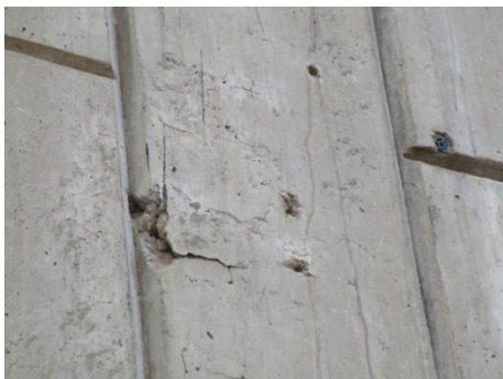
Figura 3.63. Grieta en recubrimiento en unión trabe-columna. Foto 23.
