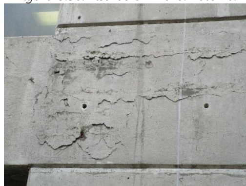
Figura 3.58. Fisuras en trabe. Foto 18.
