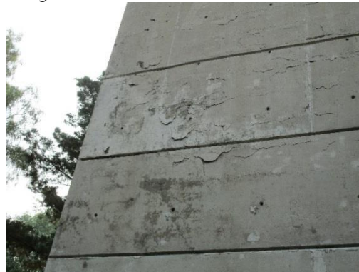
Figura 3.54. Fisuras en muro. Foto 14.
