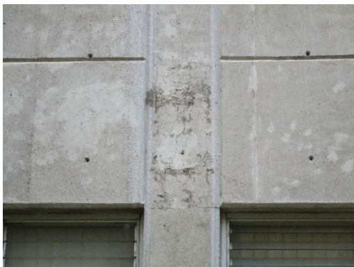
Figura 3.59. Fisuras en mapa en unión trabe-columna. Foto 19
