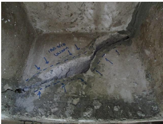
Figura 2.9. Fractura en trabe. (DE-DICYG, 2018)
