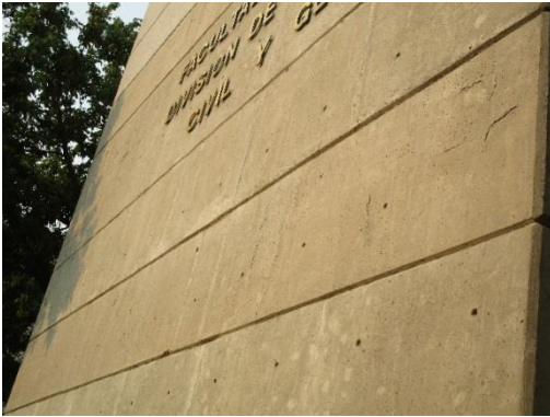
Figura 3.51. Fisuras en muro. Foto 11.
