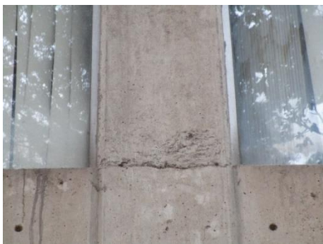
Figura 3.61. Junta fría en unión trabe-columna. Foto 21.
