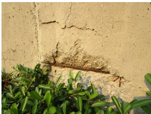
Figura 3.49. Pérdida de recubrimiento y corrosión del acero en muro. Foto 9.
