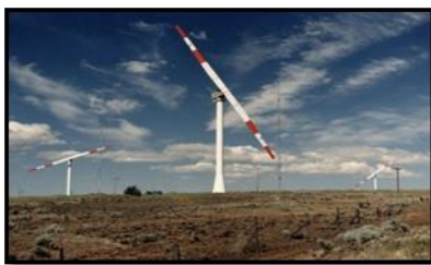
Aerogenerador Bipala Mod-5B
