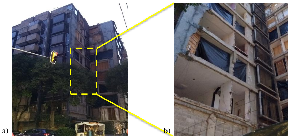
Figura 3.14. Descripción de daños en edificio CUA-133 – Riesgo Alto: a) vista exterior N-S del edificio posterior al sismo donde se observó la inexistencia de algunos muros exteriores, lo que indicó que en el inmueble ya se estaban realizando trabajos de obra, b) vista del detalle de fachada del edificio posterior al
