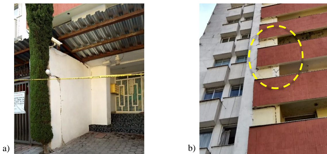
Figura 4.17. Descripción de daños en edificio BJ-42 – Riesgo Medio: a) entrada del edificio con cinta de advertencia, b) daños en muros y acabados observados en vista frontal E-W, c) daños en el interior del edificio (2018) (Imagen obtenida de: https://bit.ly/2p5aPDP ), d) daño en muro interior (2018) (Imagen obtenida de: https://bit.ly/2p5aPDP ), e) daños en acabados en vista lateral del edificio dirección N-S, f) daño en columna y desprendimiento del acabado (2018) Imagen obtenida de: https://bit.ly/2p5aPDP ), g) desprendimiento del acabado en muro al interior del edificio (2018) (Imagen obtenida de: https://bit.ly/2p5aPDP ), h) daños en muros de torre contigua, i) colocación de contraventeos entre las dos torres, vista N-S y j) visualización de colocación de acero de refuerzo en la planta baja, dirección E-W.
