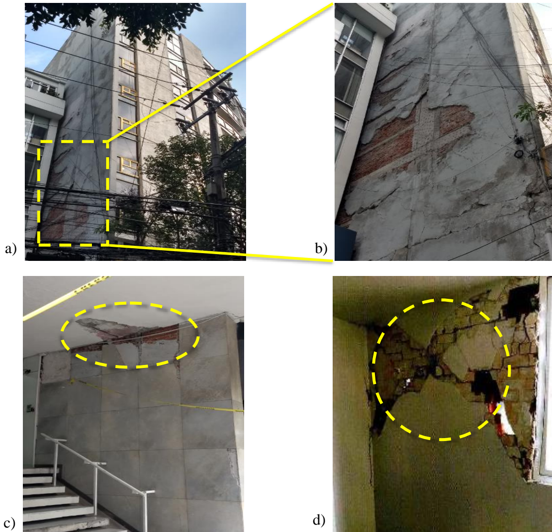
Figura 3.18. Descripción de daños en edificio CUA-17 – Riesgo Alto de Colapso: a) vista exterior N-S del edificio posterior al sismo, b) desprendimiento del acabado en muros exteriores, c) desprendimiento de acabados en muros de la entrada del edificio, d) fracturas en muro interior de uno de los departamentos (2018) (Imagen obtenida de: https://bit.ly/2ZYf3hU ), e) y f) colapso parcial en muros interiores del edificio (2018) (Imágenes obtenidas de: https://bit.ly/2ZYf3hU ), g) grieta diagonal con abertura considerable en muro interior (2018) (Imagen obtenida de: https://bit.ly/2ZYf3hU ) y h) fisura diagonal en columna de la planta baja, además se observó muro interior con desprendimiento de acabado (2018) (Imagen obtenida de: https://bit.ly/2ZYf3hU ).
