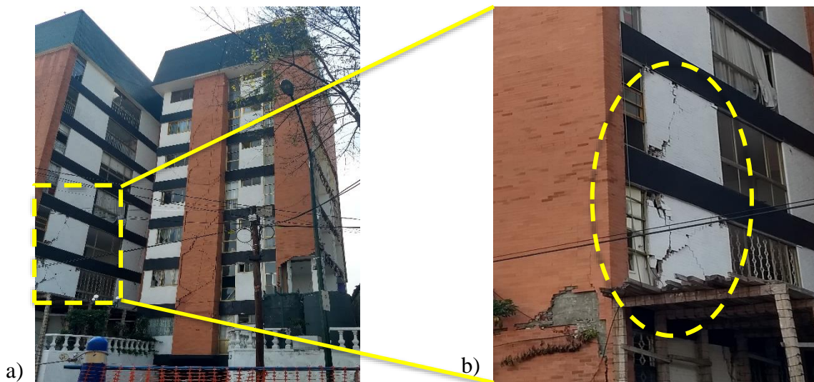
Figura 3.15. Descripción de daños en edificio BJ-57 – Riesgo Alto: a) vista exterior E-W de una de las torres del edificio posterior al sismo donde se pudo observar el daño en muros exteriores en la mayoría de sus niveles, b) detalle del daño en algunos de los muros exteriores del edificio en los que se presentaron grietas en diagonal y en forma de “X”, c) vista exterior E-W de otra de las torres del edificio en las que se
