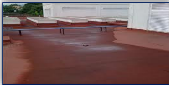
Figura 2.2.- Azotea con agua encharcada
