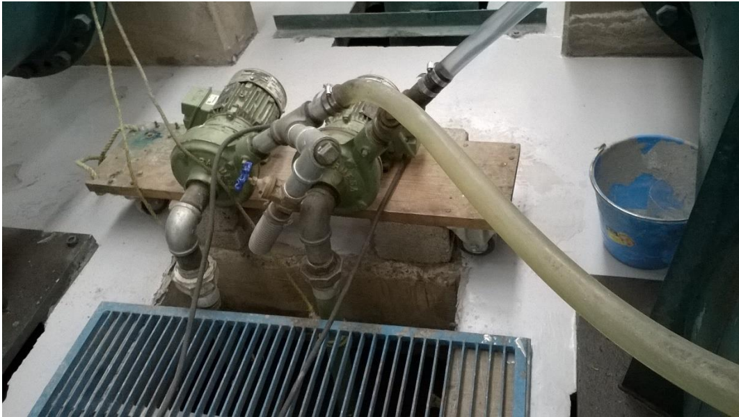
Fotografía 1.11 Bombas de 3 Hp
