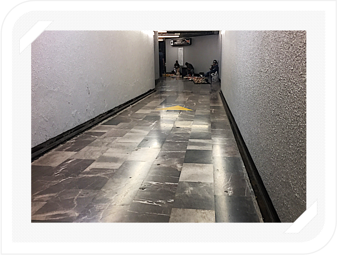
Ilustración 29 Estación Chabacano_Comercio informal en pasillo. Fuente: Visita técnica (2018).
