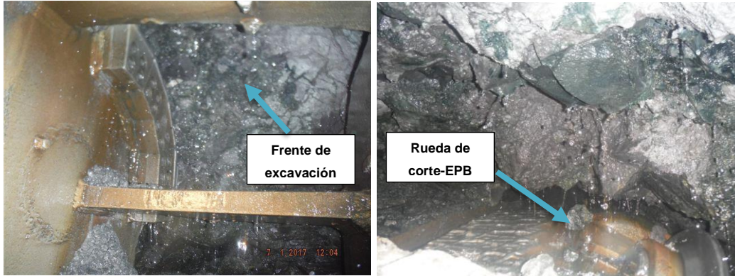
Figura 5.6 Inspección del frente de excavación desde las ventanas de la rueda de corte de la EPB (COMISSA 2017).
