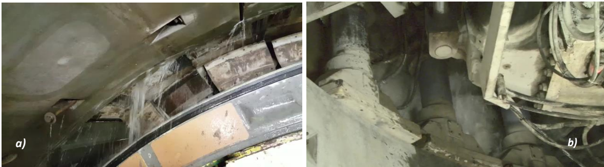
Figura 3.20 Flujo de agua hacia el interior del túnel por daños en lo cepillos; a) clave del túnel; b) cubeta del túnel.
