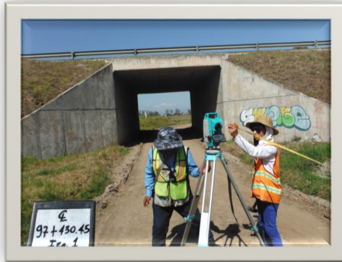
Alcantarilla Tipo Cajón
