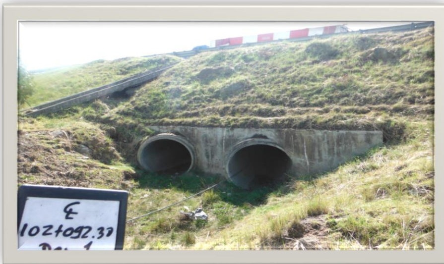
Alcantarilla de doble Tubo de Concreto
