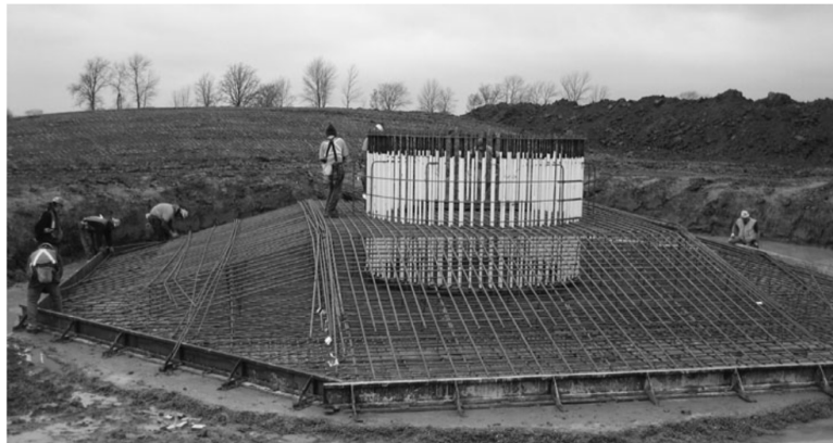
Figura 1.1. Base de una turbina eólica [4]. Fotografía por Invenergy.
