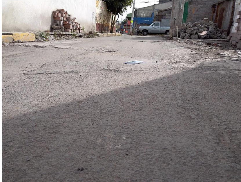
• Figura 30-4. Calle con hundimiento diferencial.
