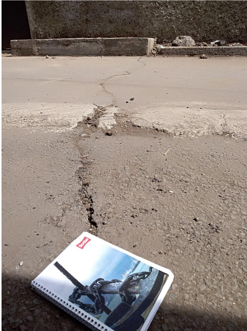
• Figura 33. Grieta con apertura de 3 cm.
