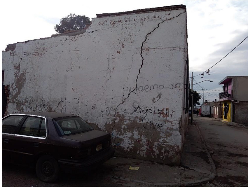
• Figura 23. Agrietamiento N-S
