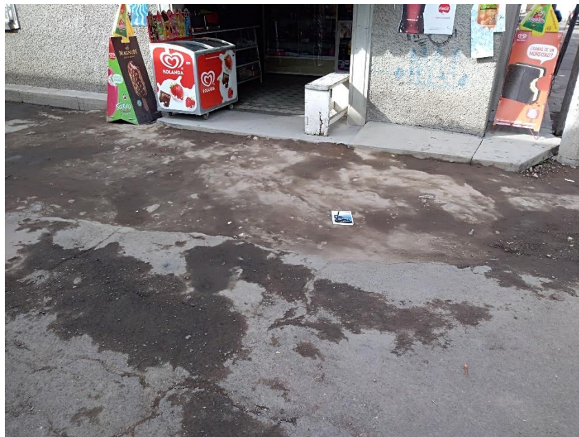
• Figura 23-1. Socavón rellenado por pobladores.
