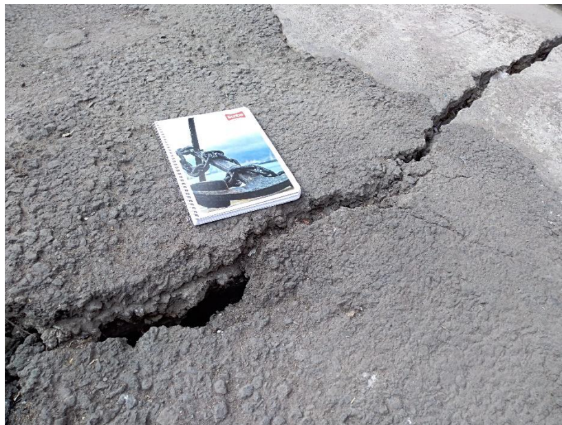
• Figura 31. Grieta con profundidad de 48 cm.
