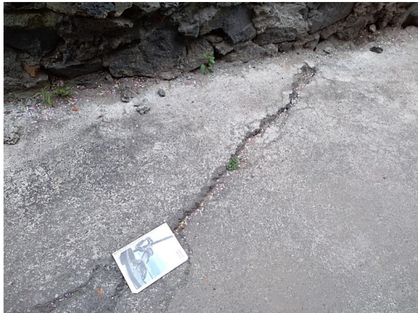
• Figura 26. Grieta con orientación 247^{\circ}
