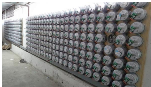
Fig. 34: Tableros para pruebas con 192 medidores eléctricos.
