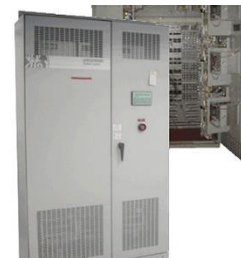
CUARTO DE CONTROL [Foto]. (2016, 12 FEBRERO). RECUPERADO 5 ABRIL, 2019, DE GEA31542A_MARK_VIE_PLATFORM_UPGRADE_FACT 1
