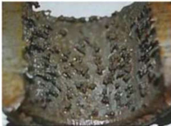
Figura 3.4 Corrosión por CO 2 (Martin, y otros, 2016).
