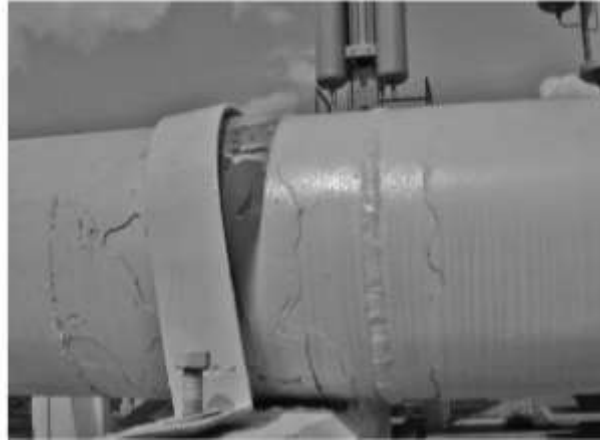
Figura 1.9 Corrosión por grietas debajo de la correa de restricción de una tubería (Lund, Enning, & Lee, 2017).
