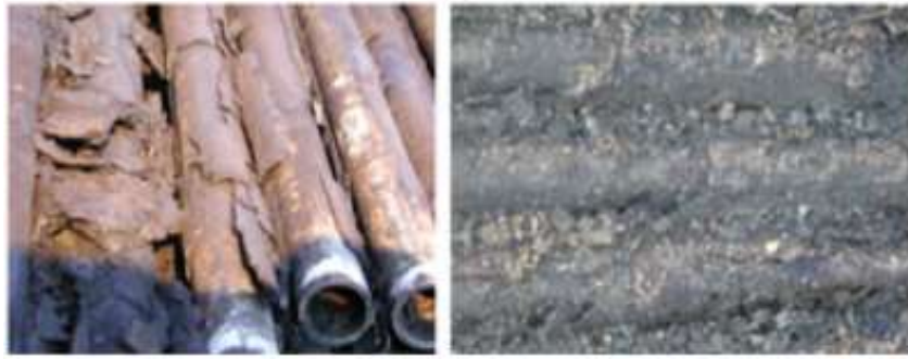
Figura 1.2 Corrosión por sulfhídrico a alta temperatura (Groysman, 2017).
