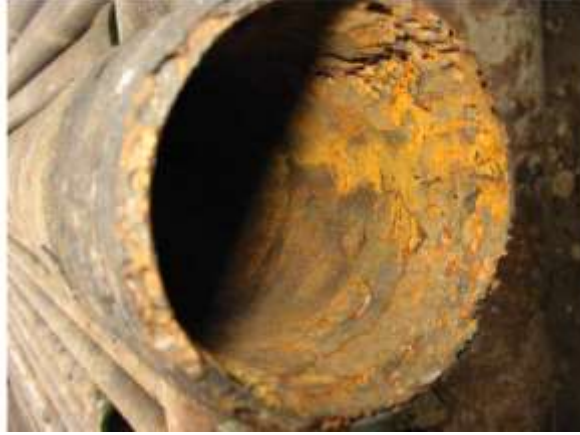
Figura 1.11 Erosión corrosión por \text{CO}_2 en una TP (Pan American Energy, 2007).
