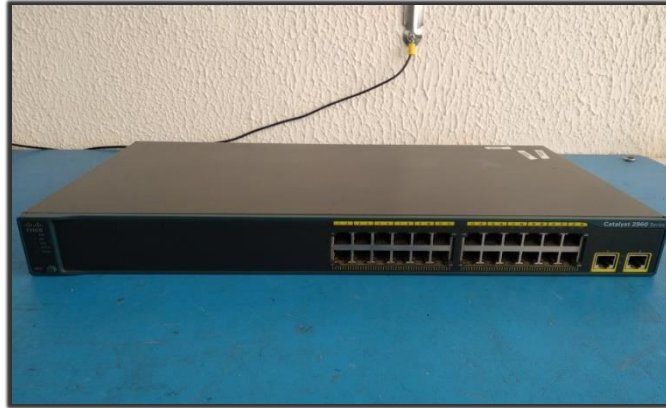
Figura 10. Switch CISCO Catalyst 2960 Serie (Fotografía tomada por el autor).
