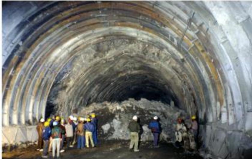
Figura 16. Hoek, E. & Marinov, P. (2000). Problemas con squeezing en túnel de 10 m a través de una zona de falla, con 1 m de desplazamiento hacia el interior. [Figura] Recuperado de “Predicting tunnel squeezing problems in weak heterogeneous rock masses”.
