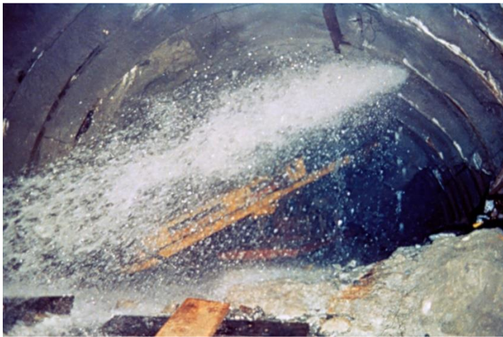
Figura 8. Irrupción de flujo de agua hacia el interior, Túnel Walgau. Fuente: AMITOS.
