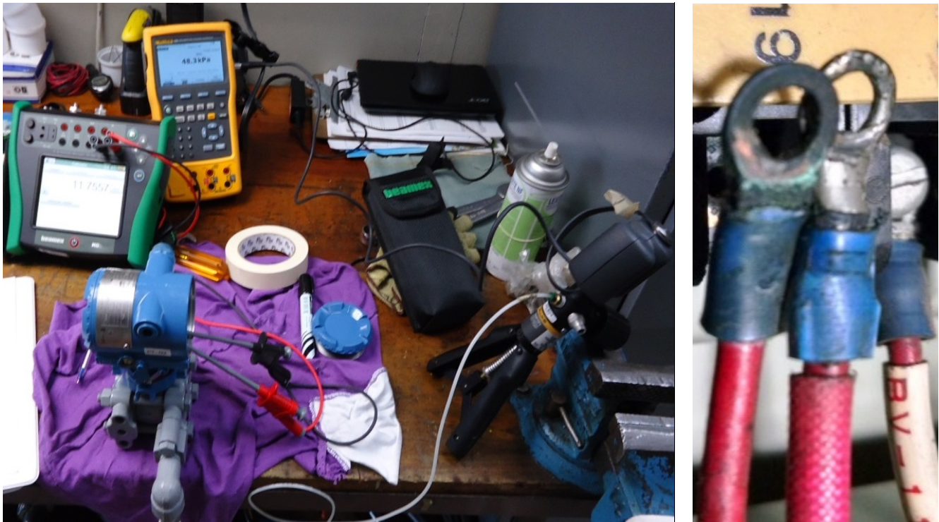
Figura 18.- Revisión del PIT 10LBA03CP002 con apoyo de instrumentos patrón (izquierda). Terminales sulfatadas (Derecha).
