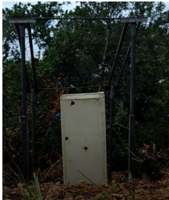
Figura 71. Montaje especial para las celdas y armario para colocar las baterías de ciclo profundo.
