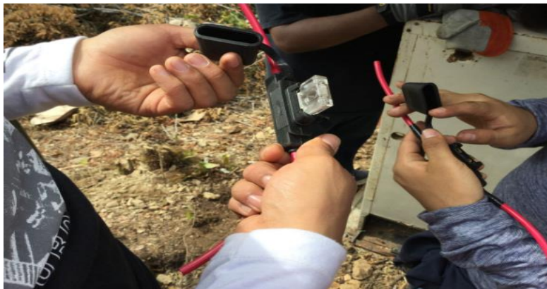
Figura 75. Fusibles para protección del conector MC-4. Recuperado de: Visita técnica Agosto, 2017.
