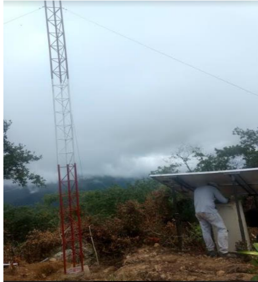
Figura 79. Instalación del sistema de alimentación. Recuperado de: Visita de Campo.
