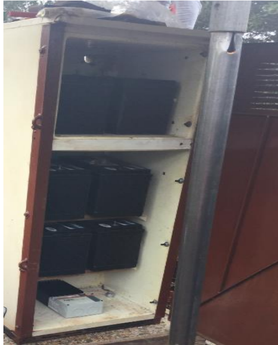
Figura 78. Colocación del regulador de carga y baterías en el refrigerador. Recuperado de: Visita de Campo.
