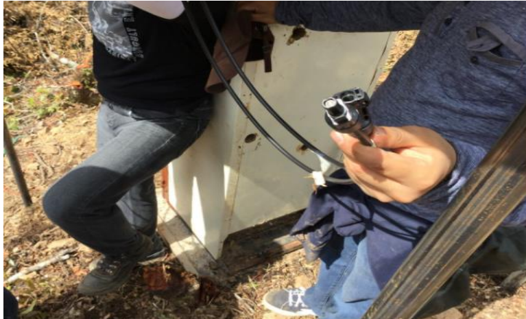
Figura 74. Conectores MC-4 Macho. Recuperado de: Visita técnica Agosto, 2017
