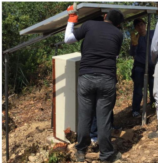
Figura 68. Paneles fotovoltaicos y estructura para sostener los paneles fotovoltaicos.
