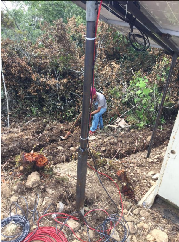
Figura. 77 Cables encinchados. Recuperado de: Visita de técnica Agosto, 2017
