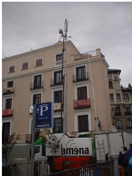
Figura 15. Ejemplo de instalación de antena de telefonía celular. Recuperado de: http://emercomms.ipellejero.es/2009/08/06/bts-moviles-en-redes-de-telefonía-celular/
