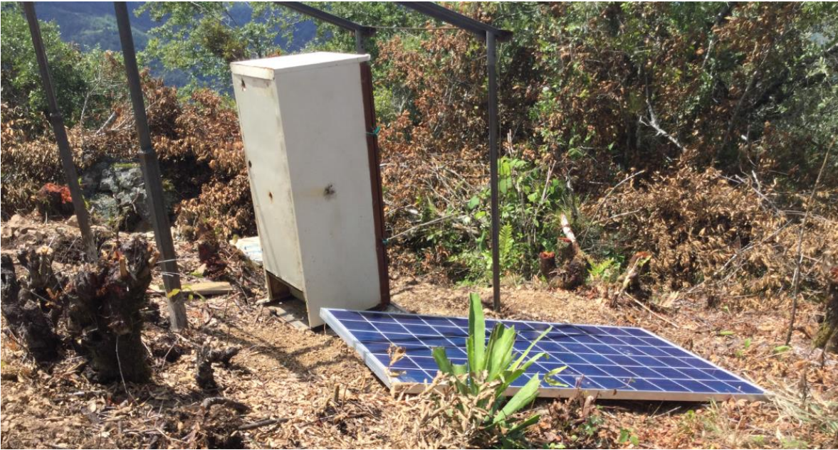
Figura 69. Día de la instalación de los paneles. Recuperado de: Visita técnica Agosto, 2017
