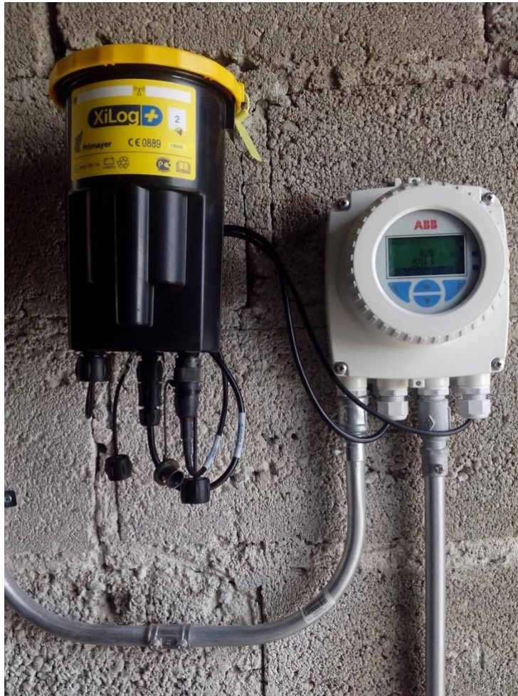
Ilustración 22. Ejemplo de medidor con alimentación eléctrica alterna, 110V.
