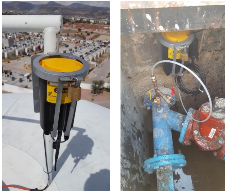
Ilustración 10. Instalación de los dataloggers, medición de nivel (izq.) y medición de presión (der).
