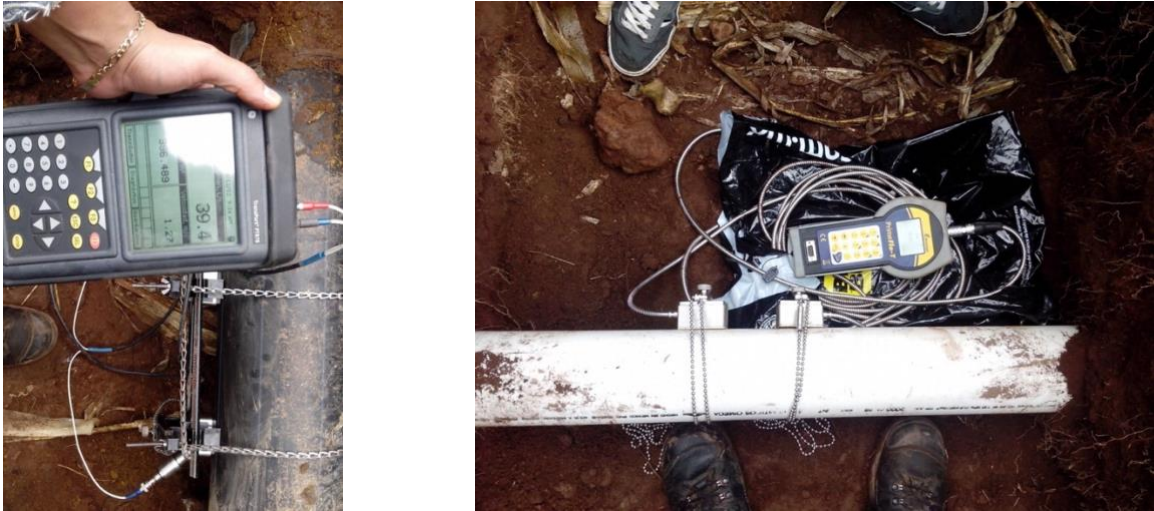
Ilustración 26. Medidores ultrasónicos utilizados en el proceso de calibración.
