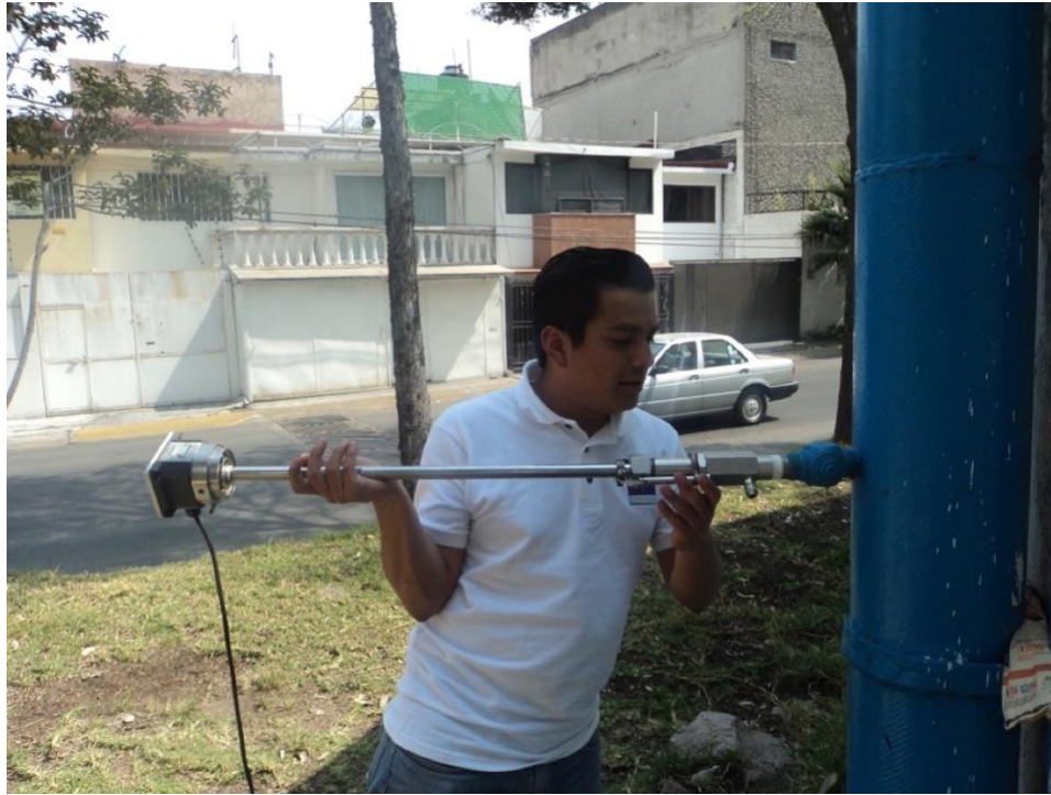
Ilustración 19. Medidor de inserción instalado.
