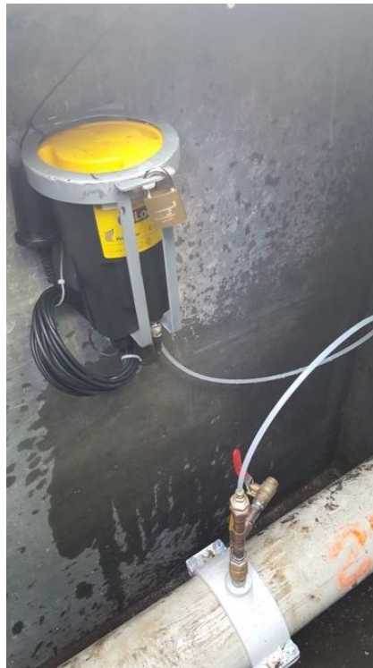
Ilustración 17. Equipo instalado, programado y listo para monitoreo.
