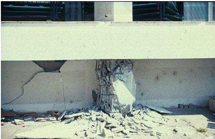
Imagen 2.03. Falla de una columna corta en el Hotel Korali, durante el sismo de Montenegro ,1979.
