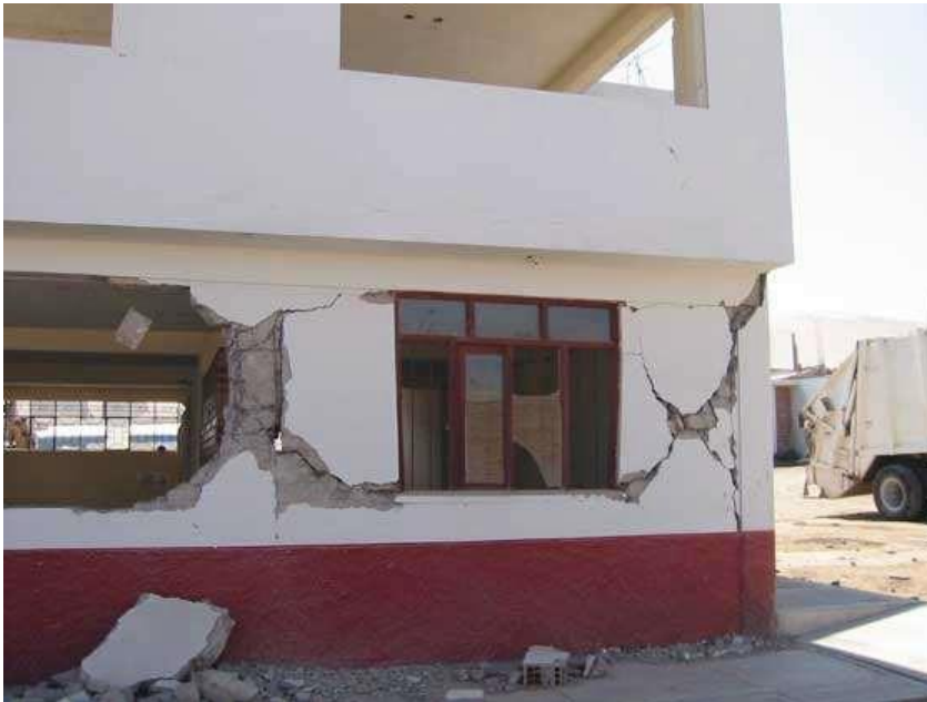
Imagen 2.01. En esta imagen se muestran los daños causados por el efecto de columna corta tras un sismo. Se puede observar la configuración típica (columnas con muros intermedios).
