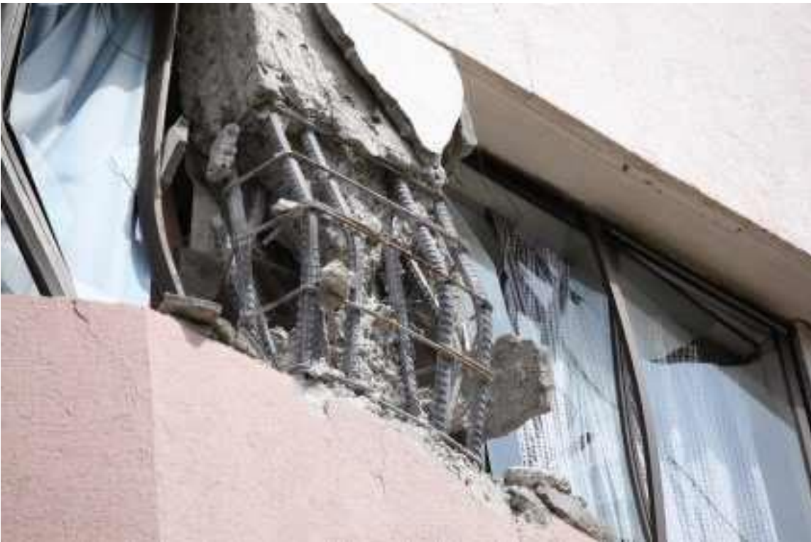
Imagen 2.07. Edificio habitacional con daños en las columnas cortas durante el sismo de 1996 en Chile. Se observa claramente la configuración estructural que predispone a la edificación a presentar este tipo de daño
