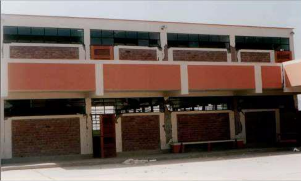
Imagen 2.06. Escuela dañada por sismo de 1996, Perú. Presenta daños en las columnas cortas.
