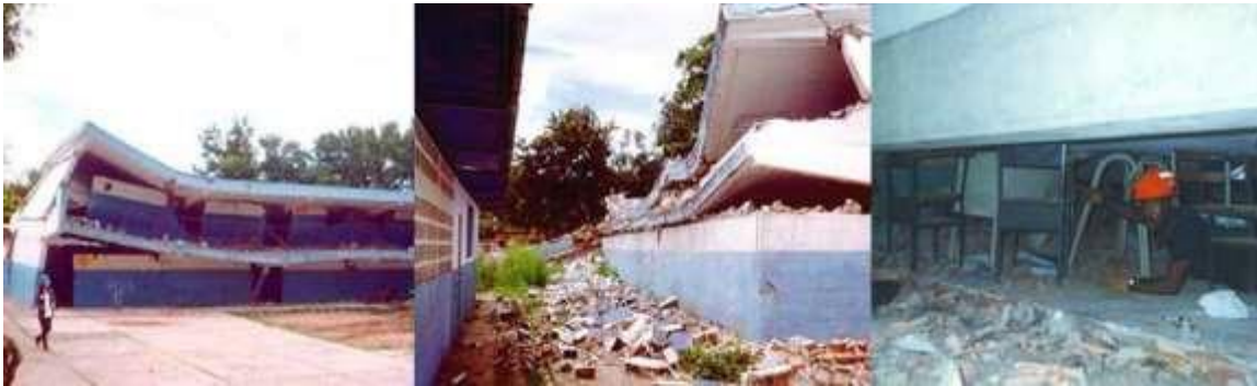
Imagen 2.09. Daños en edificio escolar (Liceo Raimundo Martínez Centeno) durante el sismo de 1997 en Venezuela. Murieron 33 personas a causa de la falla de este edificio.
