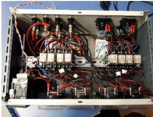
Figura 1.4 Contenido interno del antiguo sistema de alimentación.
