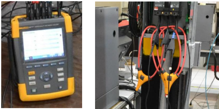
Figura 3.3. Conexión del analizador de redes FLUKE® 435 Series II a la instalación eléctrica del centro de maquinado (imagen izquierda) y analizador de redes en funcionamiento (imagen derecha).
