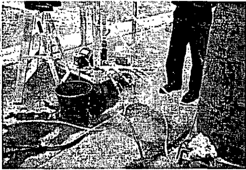
Múltiple, conexión hacia 5 pozos de extracción
