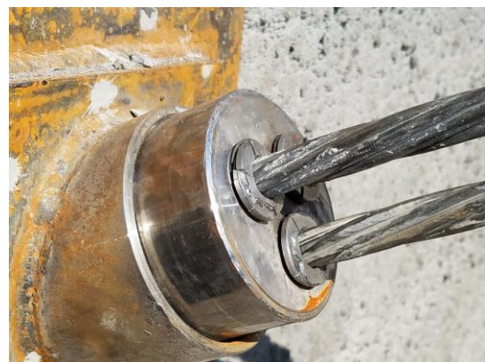
Figura 5.60 Grietas y fisuras en cuñas de tensión después de tensar el ancla
