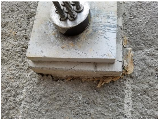
Figura 5.41 Falla a compresión del "grout" de repartición
