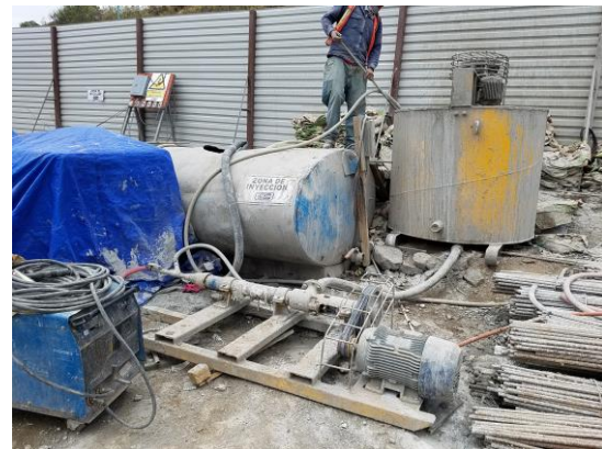
Figura 5.28 Central de lechada y bomba "Moyno"
