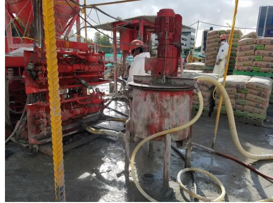
Figura 5.73 Central de lechada
