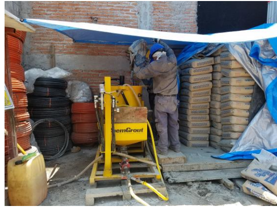
Figura 5.50 Central de lechada
