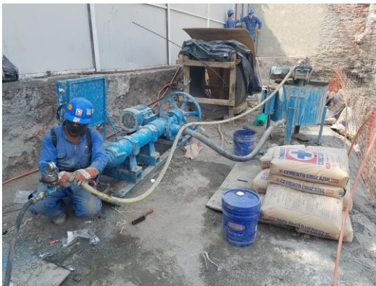
Figura 5.15 Central de lechada
