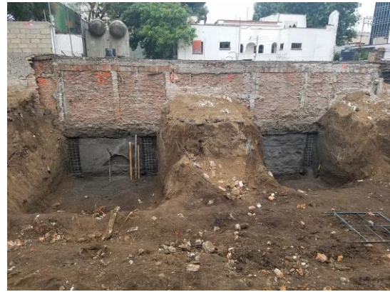
Figura 5.56 Socavación en muros de concreto lanzado
