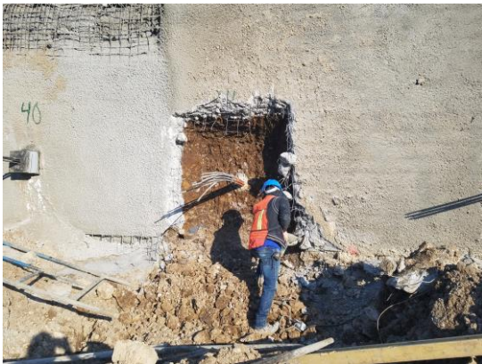
Figura 5.39 Demolición de muro y zapata de reacción fallada por capacidad de carga
