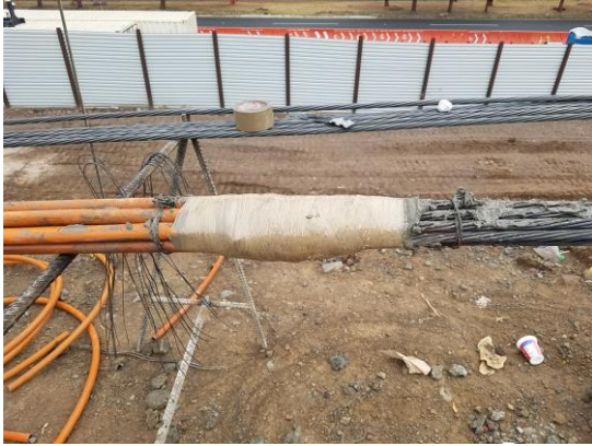
Figura 5.37 Escorrido de lechada del interior de la longitud libre
