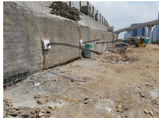
Figura 5.40 Falla de anclaje por fluencia del bulbo durante la puesta en tensión
