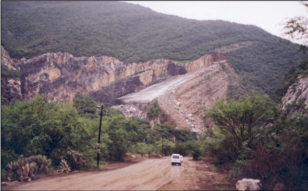
Fotografía IV.2.1. Deslizamiento de ladera en estratos gruesos de calizas debido a excavación al pie del talud.
