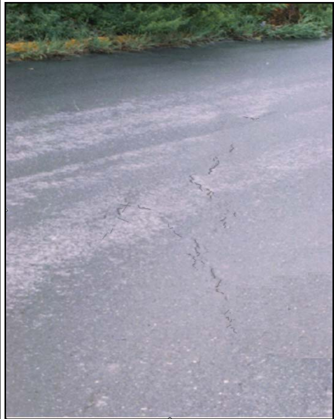
Fotografía IV.2.2.2. Agrietamientos en las vialidades.
