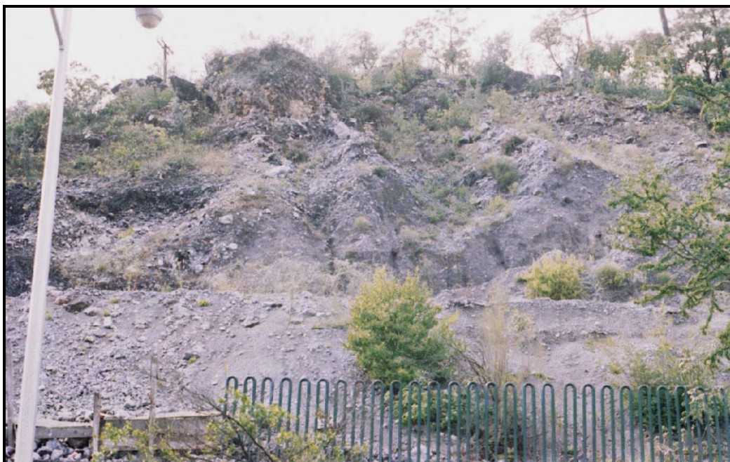
Fotografía IV.2.2.3. Ausencia de obras adecuadas para retención de caídos.
