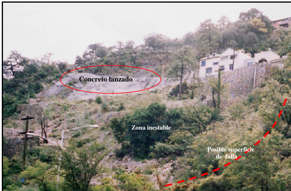
Fotografía IV.2.2.4. Concreto lanzado en la parte superior de la ladera y construcciones en la cima de esta.
