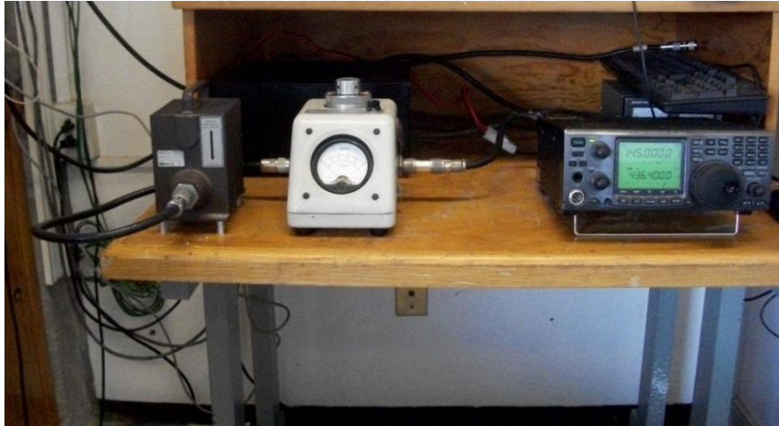
Figura 6.21 Conexión para medir fallas en la antena.
