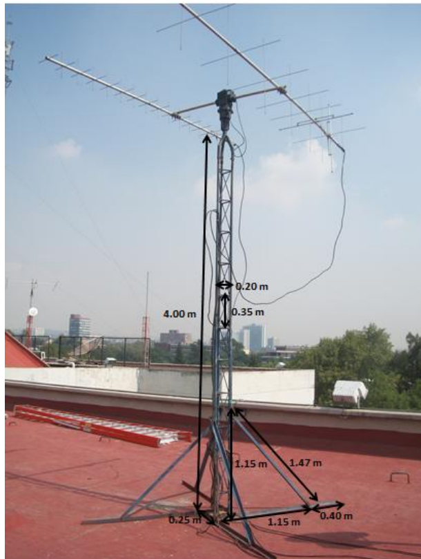
Figura 6.7 Torre de la estación terrena.
