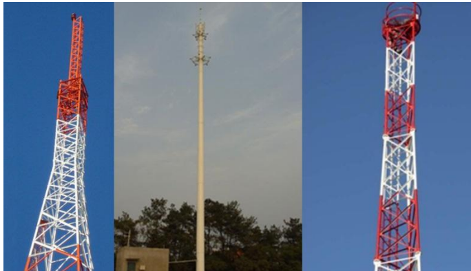
Figura 4.6 a) Torre autosoportada de sección cuadrada; b) Torre autosoportada en forma de monopolo; c) Torre autosoportada de sección triangular.
