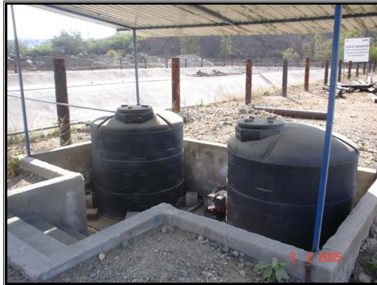
Figura 52. Tanques de almacenamiento de agua y lodos
