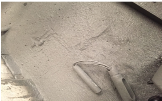
Imagen 2. Condición de los conductores eléctricos
