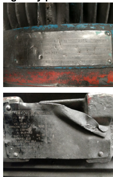
Imagen 6. Placa de datos ilegible y placa dañada.
