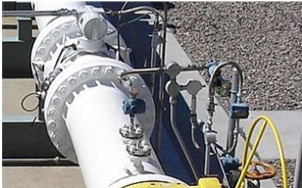
Figura 3.13 Imagen representativa de un medidor de flujo de un separador de prueba (Pemex Exploración y Producción, 2014)
