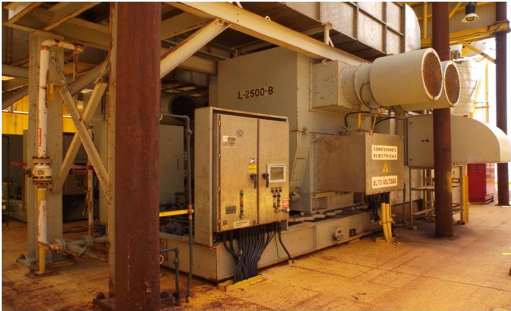
Figura 3.27 Turbogenerador (Pemex Exploración y Producción, 2014)
