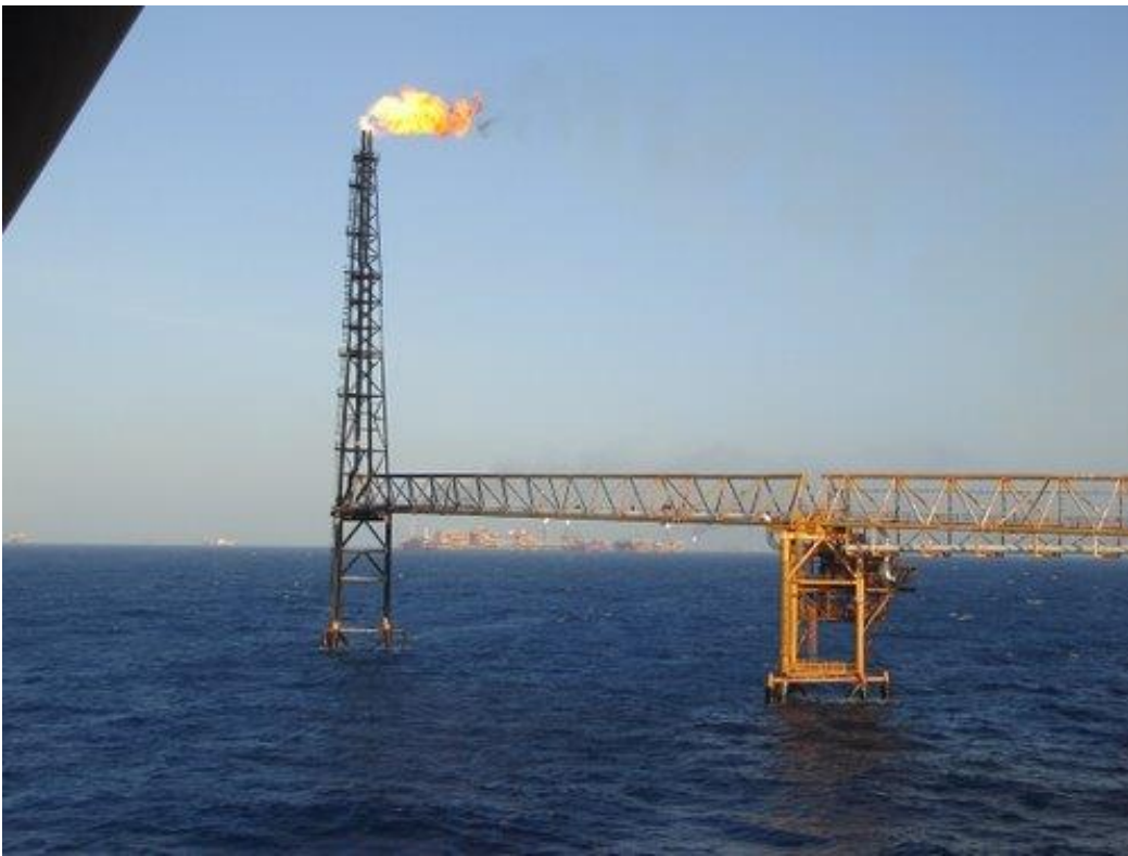
Figura 3.33 Quemador instalado en un sistema (Pemex Exploración y Producción, 2013)
