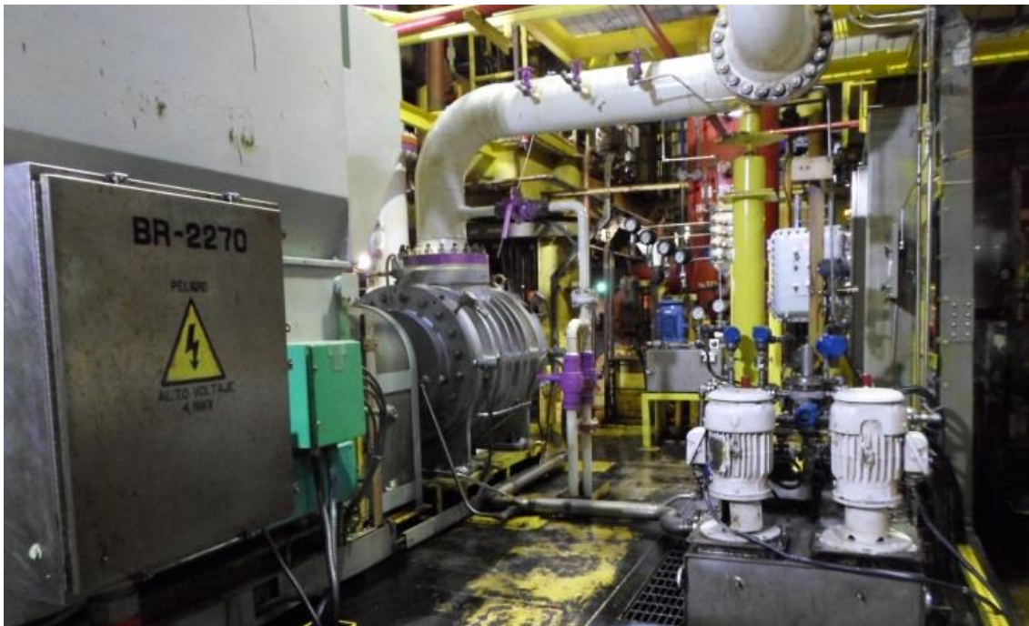
Figura 3.14 Imagen representativa de una electrobomba instalada en una plataforma de producción (Pemex Exploración y Producción, 2014)
