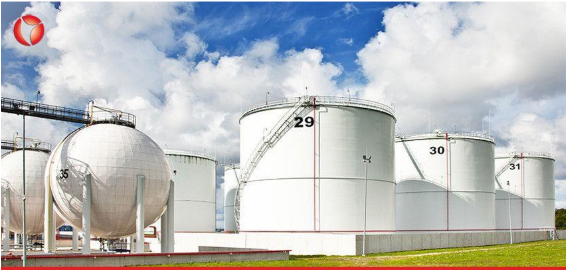
Fig. 14 Ejemplo de Tanques de Almacenamiento.
