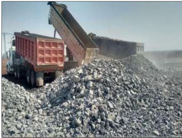
Figura 12 Colocación de material pesado de sobrecarga Pista 2, abril 2018, (Fuente: Fotografía tomada por la empresa SIPNA)
