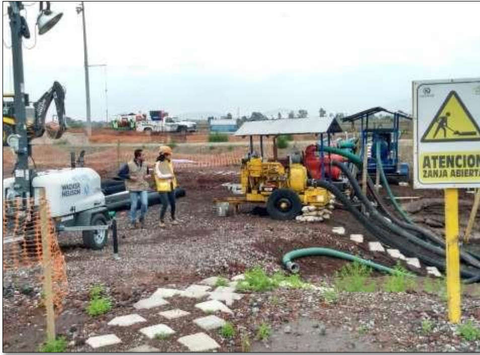
Figura 22 Medición de horómetros de bombas, (Fuente: Tomada por la autora)
