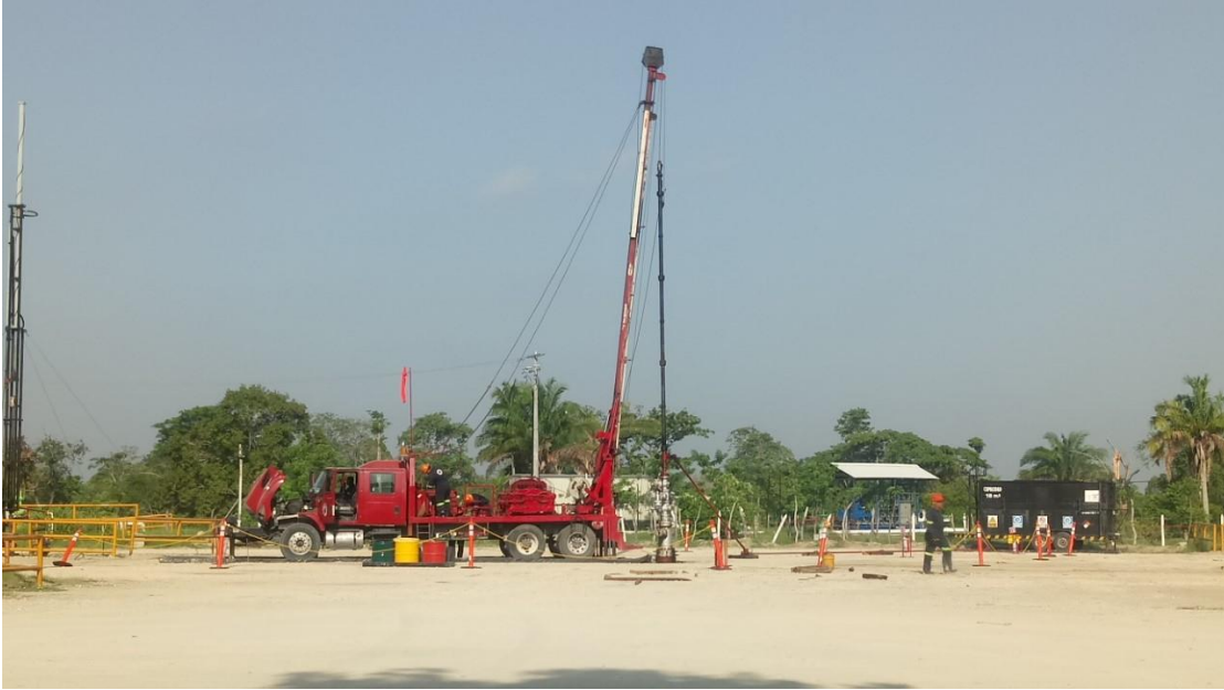
Figura 1.18 Instalaciones de Swabeo
