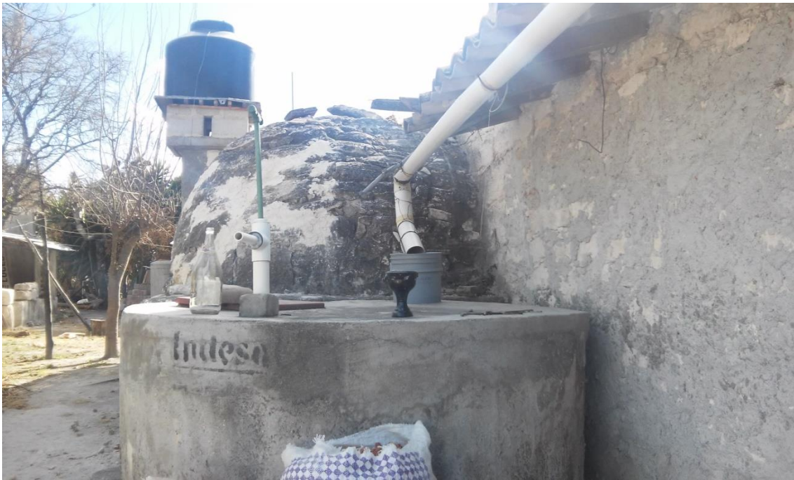
Fotografía. 6. Sistema de recolección de agua de lluvia. LCB 2018, fotografía propia.
