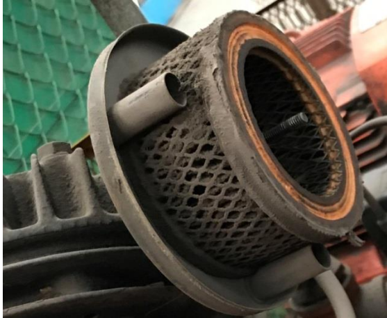
Figura 19. Filtro de entrada obstruido por el polvo, compresor 2. Fotografía de la planta.
