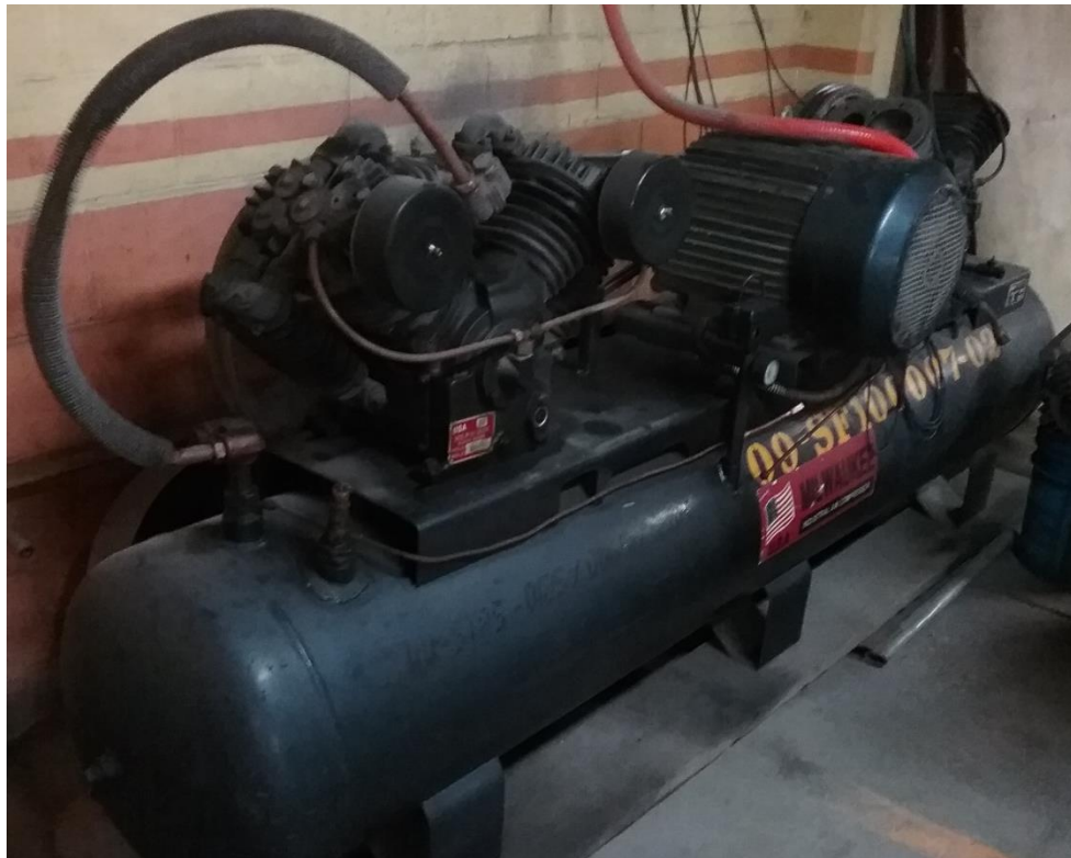
Figura 18 Compresor de 20 hp. Fotografía de la planta.
