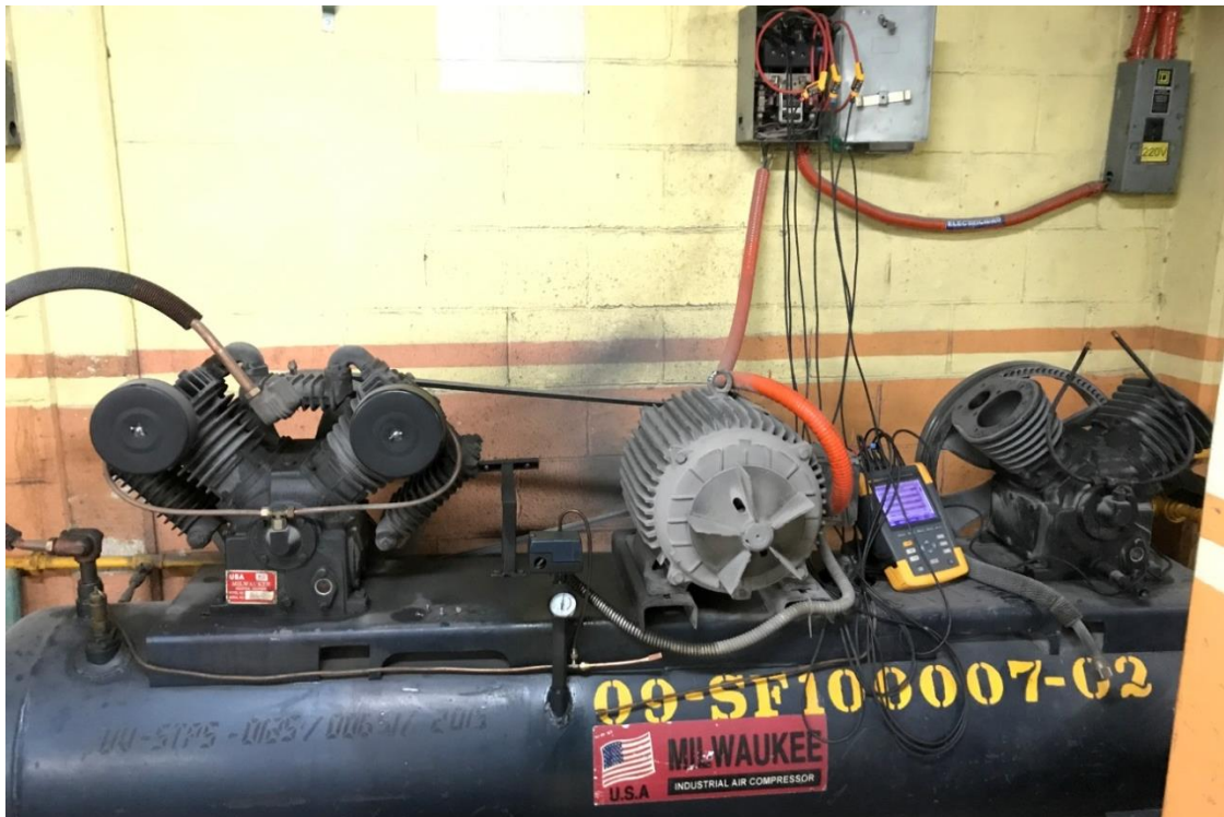
Figura 21. Compresor 3. Fotografía de la planta.
