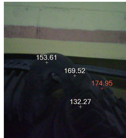
Figura 27. Distribución de temperaturas en la región más caliente del cabezal (Termografía)
