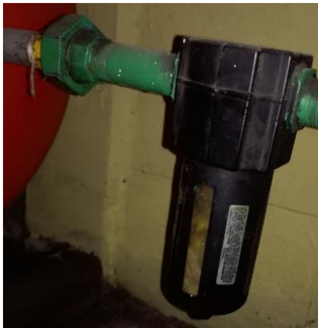
Figura 36. Filtro a la salida de tanque pulmón. Fotografía de la planta.
