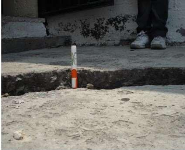
Fotografía 22. Escalón de falla en el patio
