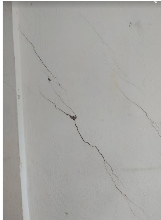
Fotografía 42. Fractura en la pared de la oficina.
