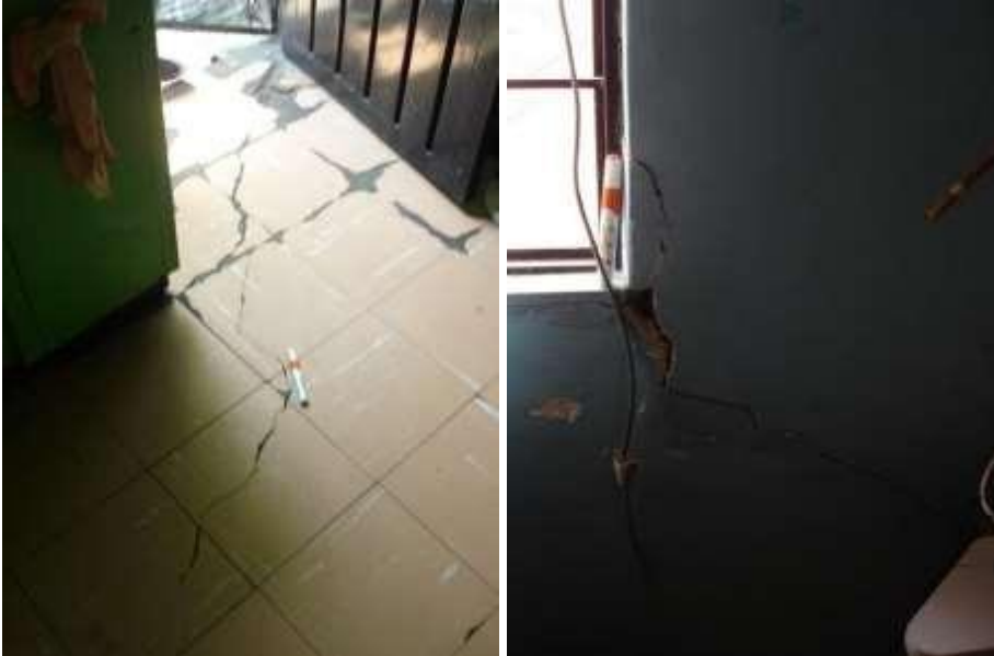
Fotografía 11. Fracturamiento en el piso de la cocina y en la pared de la segunda habitación.
