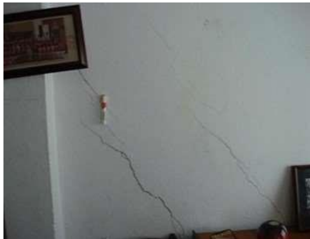
Fotografía 14. Fracturas en la pared de la oficina.
