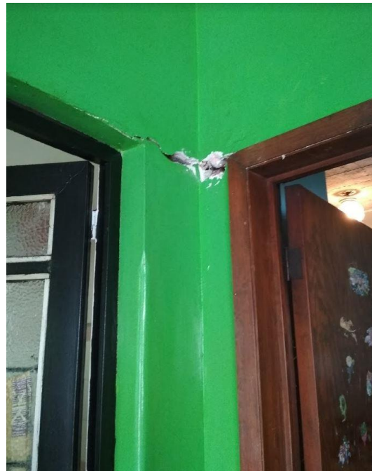
Fotografía 37. Fractura la pared entre el baño y la habitación.
