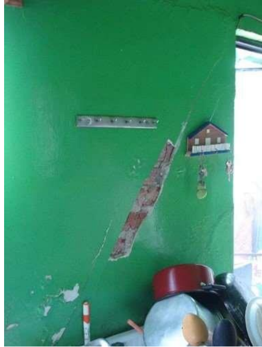
Fotografía 7. Fractura en la pared de la cocina.
