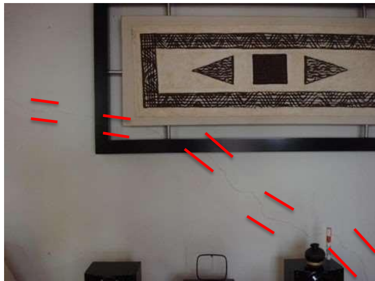
Fotografía 16. Fractura en la pared de la sala.
