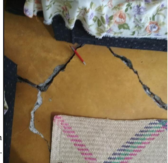
Fotografía 33. Fractura en el cuarto de descanso.
