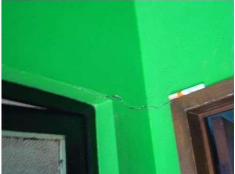
Fotografía 9. Fractura en la pared entre habitación y baño.
