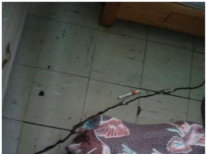
Fotografía 10. Fractura en el piso de cuarto.
