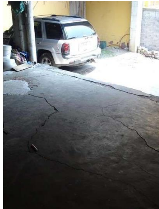
Fotografía 5. Fractura en el patio lateral de la casa
