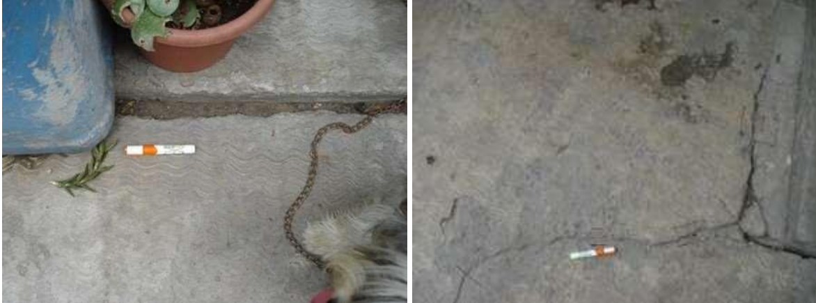
Fotografía 27. Fracturas en el patio
