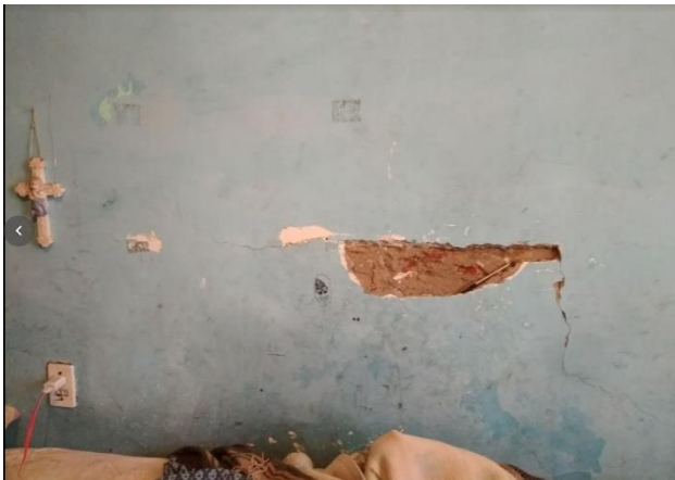
Fotografía 39. Fractura en la pared del cuarto secundario.
