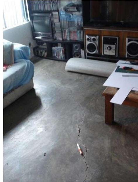
Fotografía 29. Fractura en el piso del estudio.
