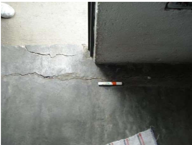
Fotografía 30. Fractura en el piso del comedor.
