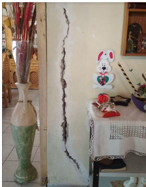
Fotografía 32. Fractura en la pared de la sala.
