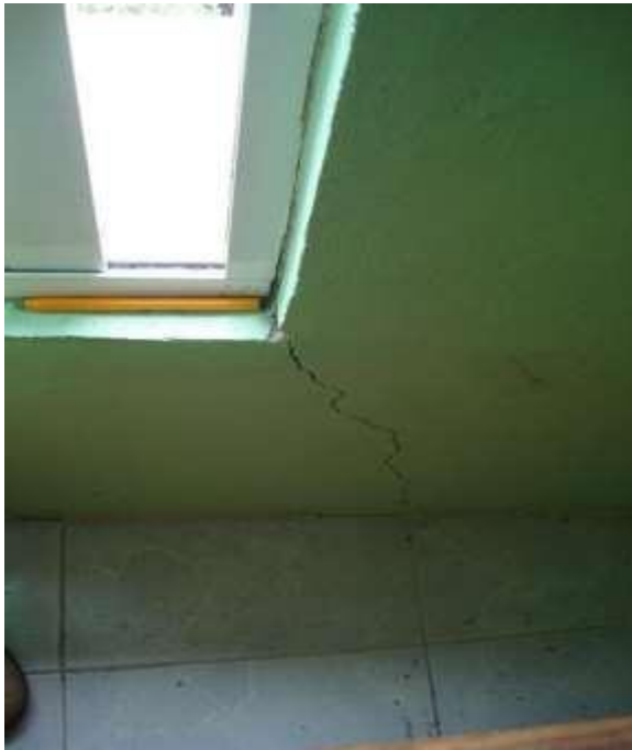
Fotografía 31. Fractura en las paredes del cuarto.
