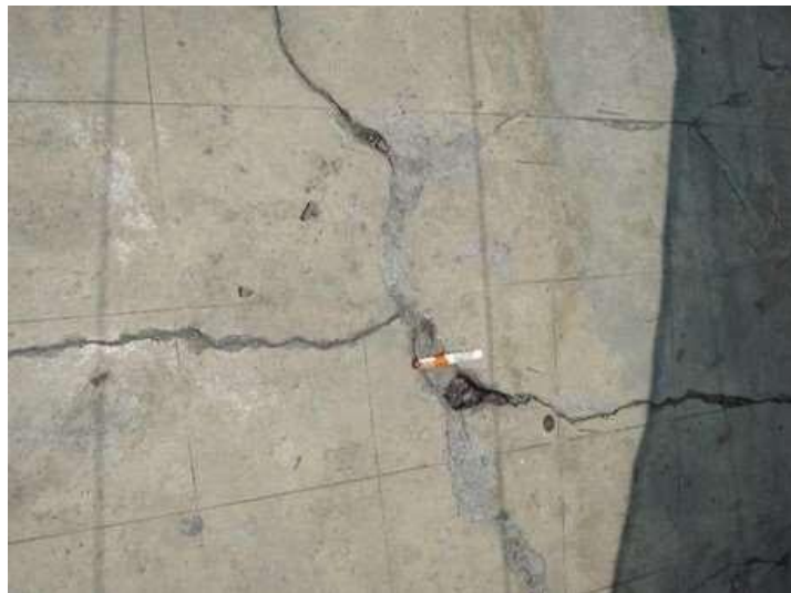
Fotografía 8. Fractura en el piso de la cocina.
