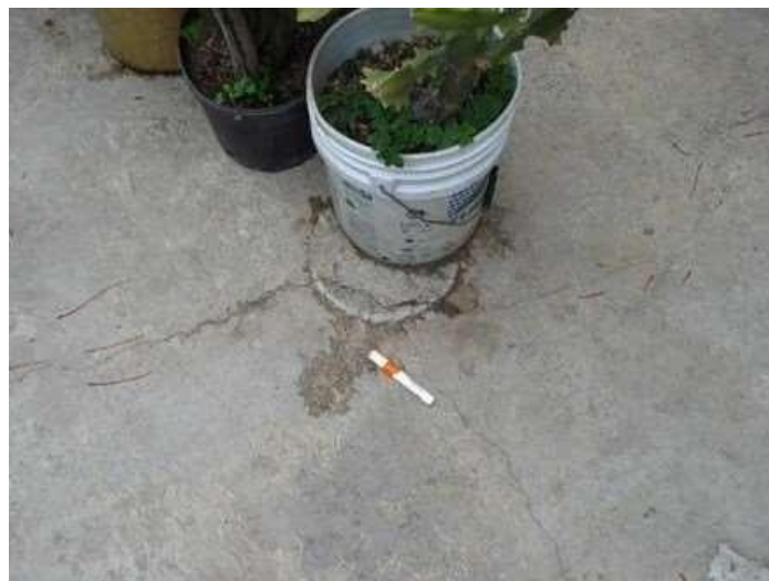
Fotografía 26. Fracturas en el patio de la casa.
