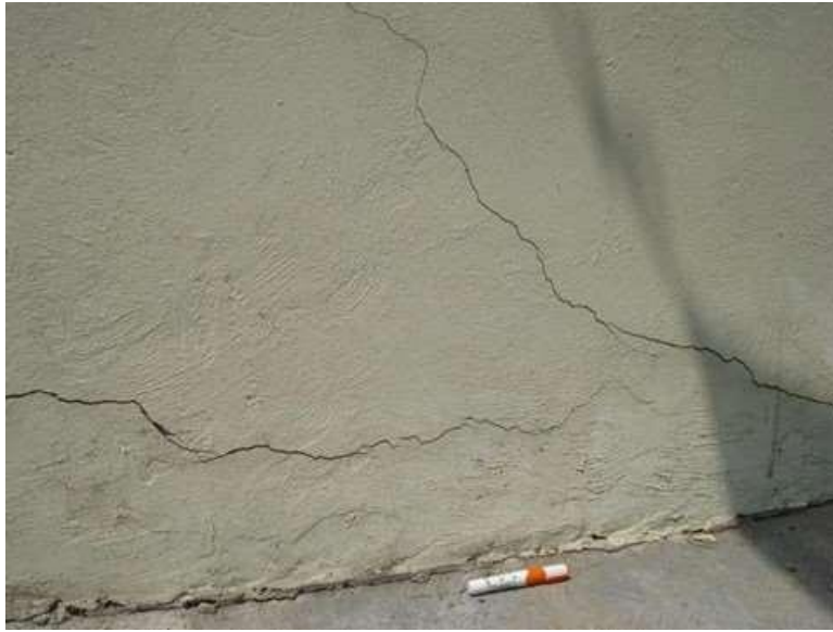
Fotografía 6. Fractura en la pared exterior de la casa.
