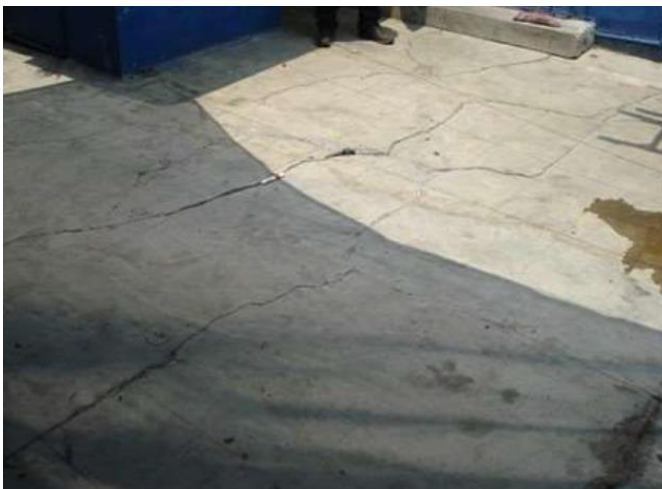
Fotografía 41. Fractura en el patio de la casa.
