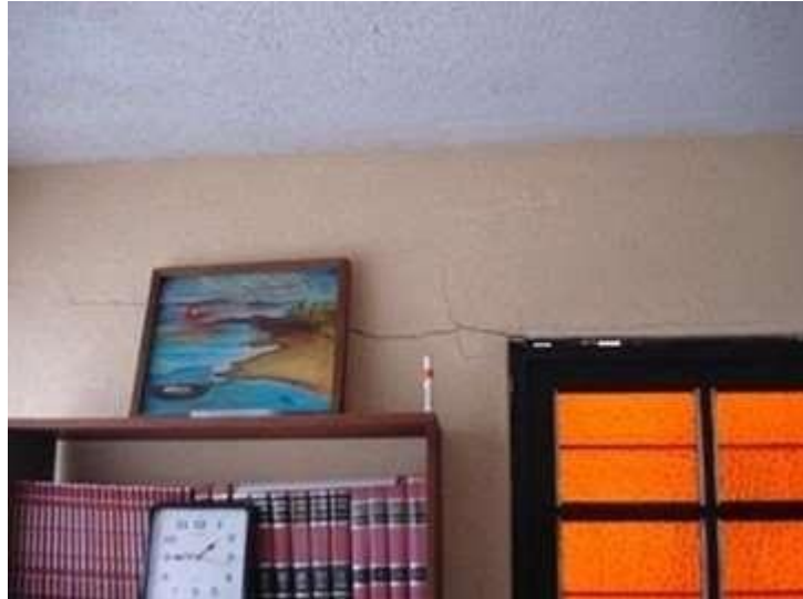
Fotografía 18. Fractura en la pared de la habitación
