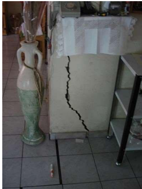
Fotografía 3. Fractura en la pared de la sala.
