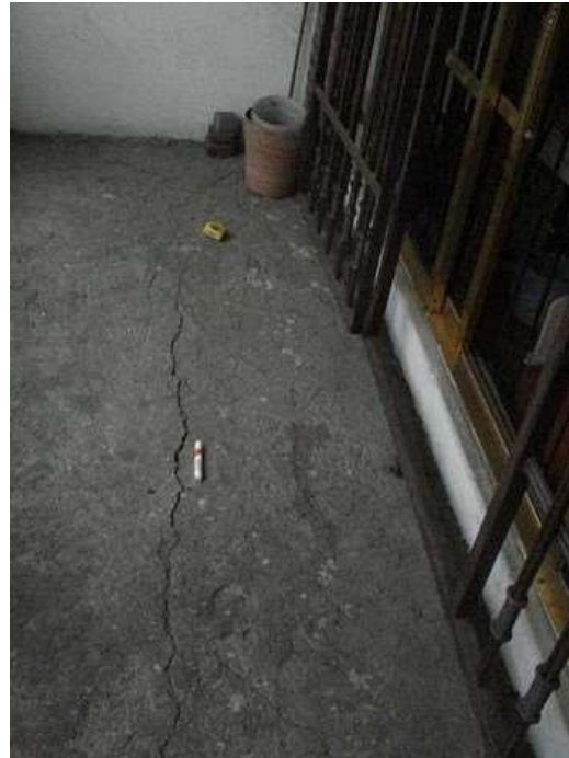
Fotografía 13. Fractura en la banqueta.
