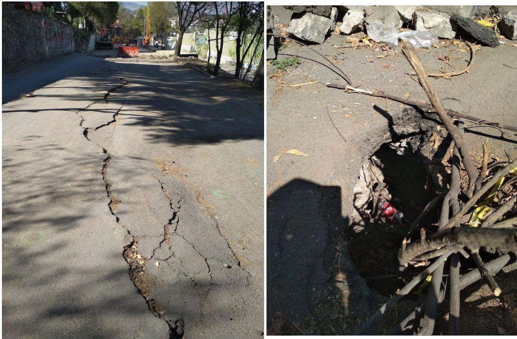
Fotografía 50. Fracturas y socavón en carretera México – Tulyehualco.
