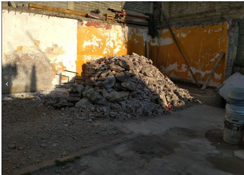
Fotografía 45. Casa en zona cerril colapsada por sismos.
