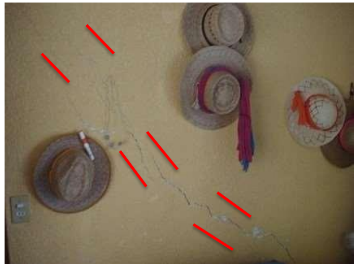
Fotografía 17. Fractura en la pared de la habitación
