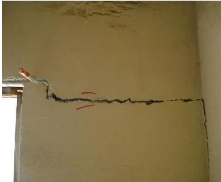
Fotografía 25. Fractura en pared detrás de la estufa.
