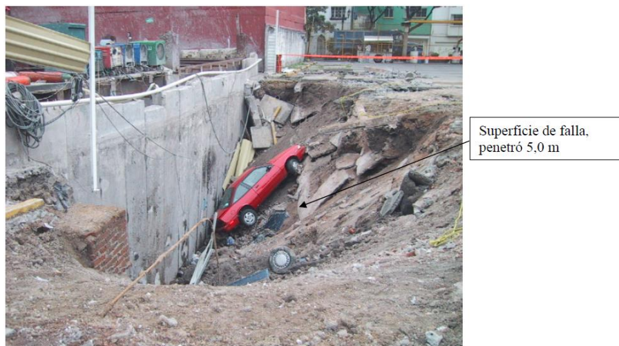
Figura 5.2. Zona de falla que se presentó en la colindancia poniente (Cuevas, 2012).
