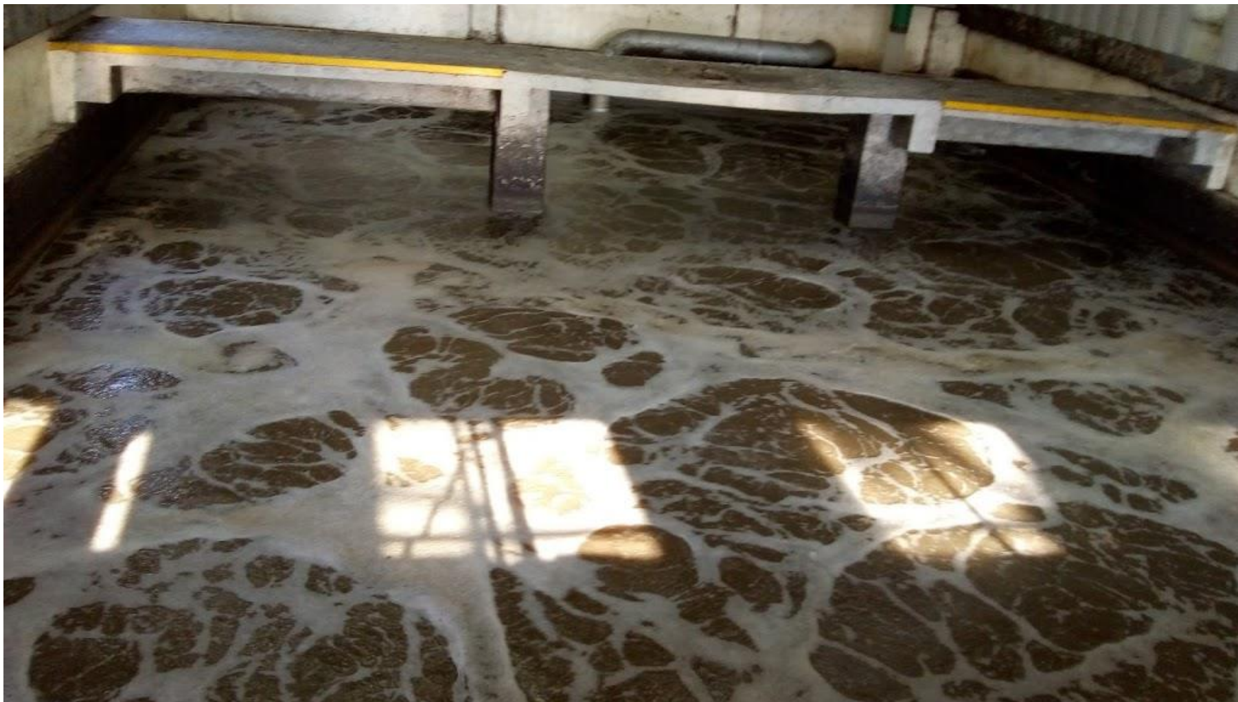
Figura A-9. Tanque de aeración de PTAR de Ciudad Universitaria.
