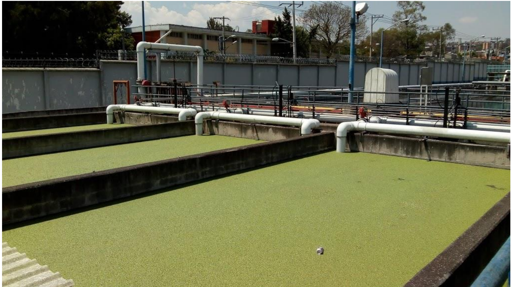
Figura A-13. Algas en tanques de almacenamiento de agua residual tratada en PTAR Cerro de la Estrella.
