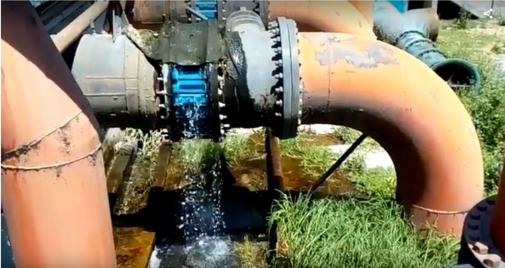
Figura A-2. Fuga de agua en PTAR Cerro de la Estrella.
