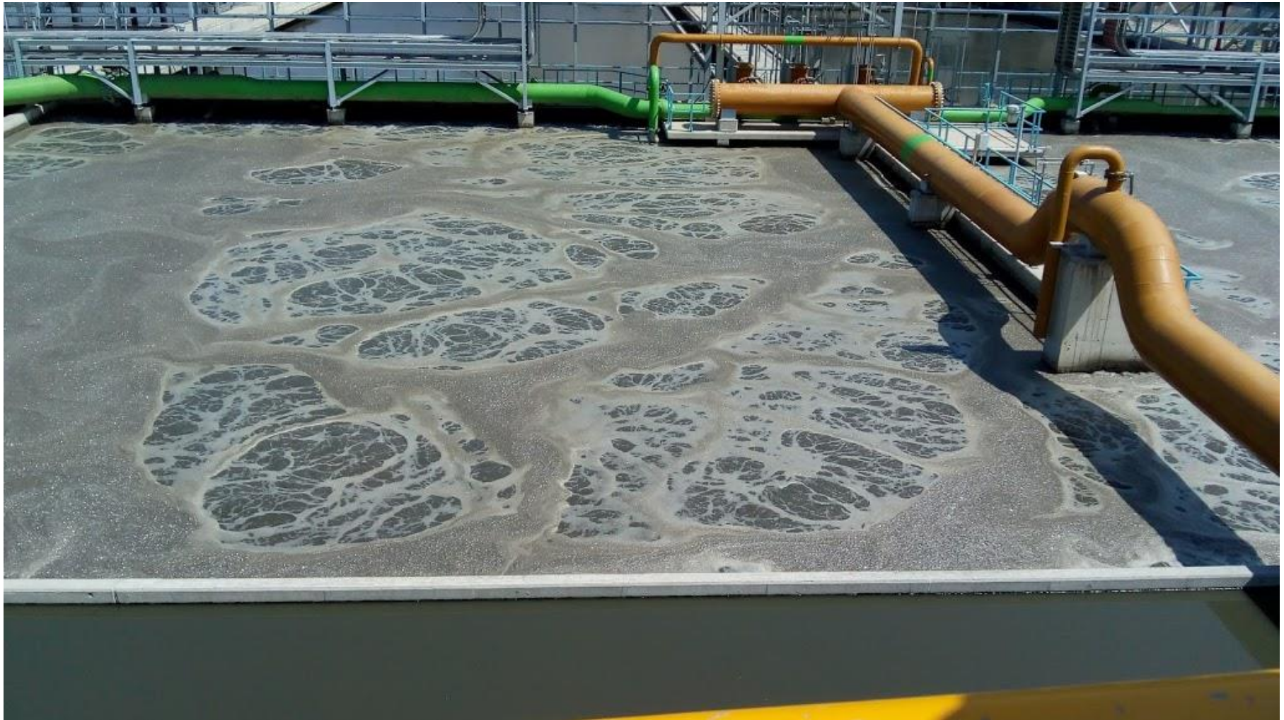
Figura A-16. Tanque de aeración de PTAR Atotonilco de Tula.
