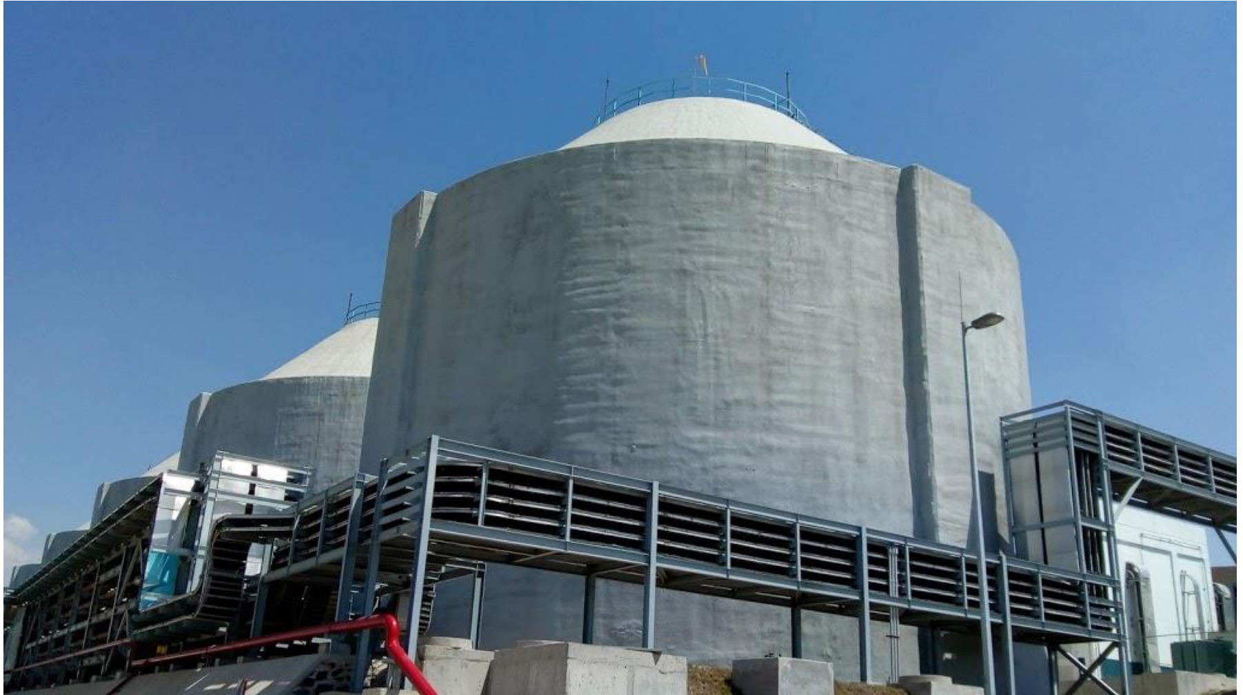
Figura A-17. Almacenamiento de biogás en PTAR Atotonilco de Tula.
