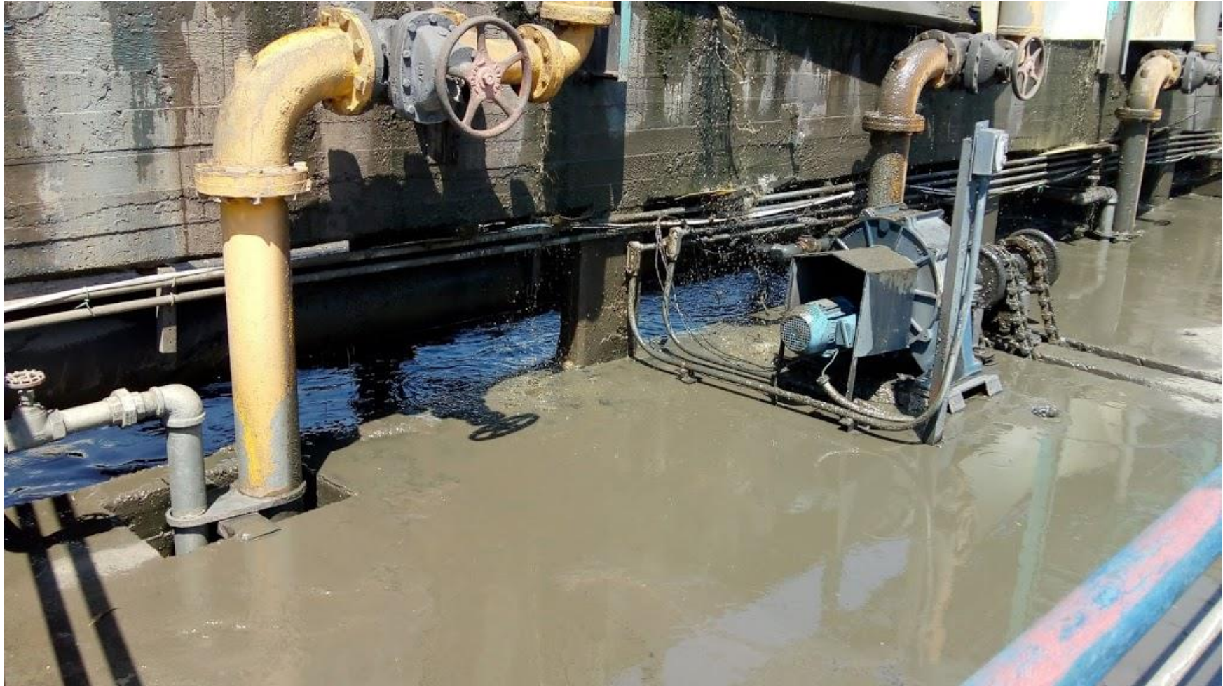
Figura A-12. Fuga de lodos en PTAR Cerro de la Estrella.
