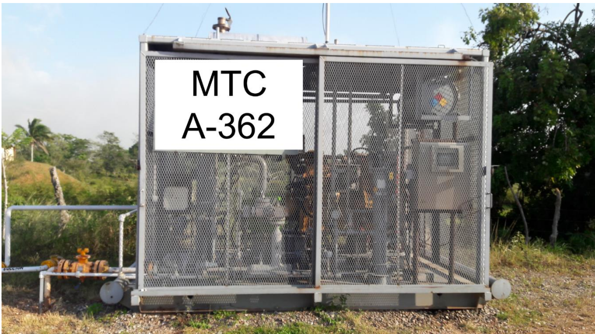
Figura 17. Motocompresor fijo tipo B.
