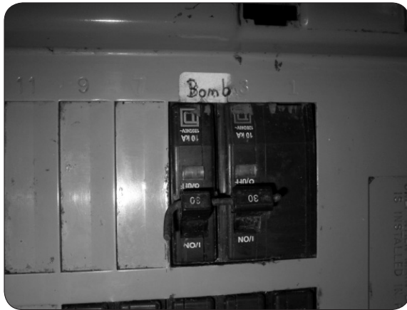
Figura 2.25 Pastillas interruptoras termomagnéticas para accionar la bomba
