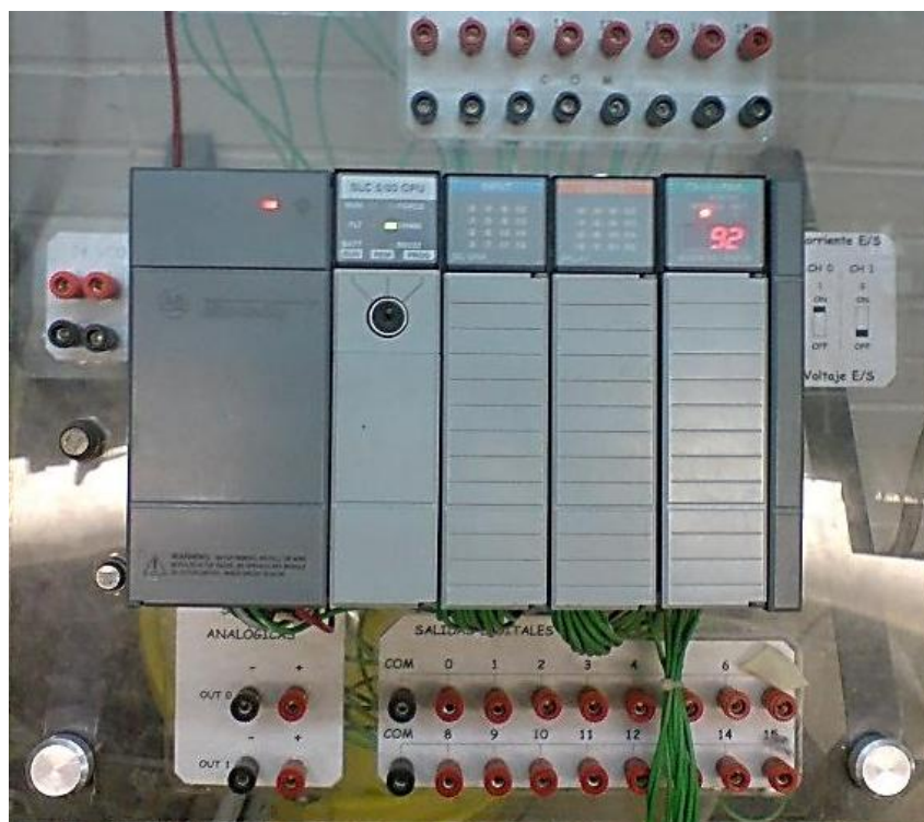
Figura 2.7. PLC SLC 500 montado en su estación de trabajo con todos los módulos conectados.
