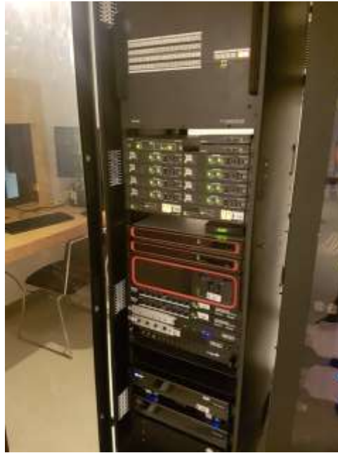
Figura 2.4 Rack con equipamiento de audio y video
